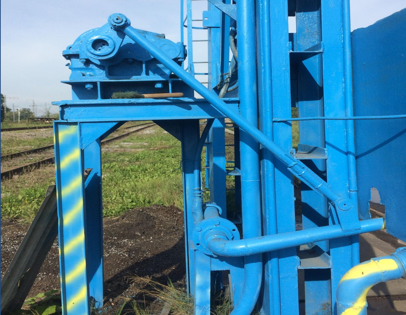
Рис. 3 – левый гидромонитор очистки вагонов.
