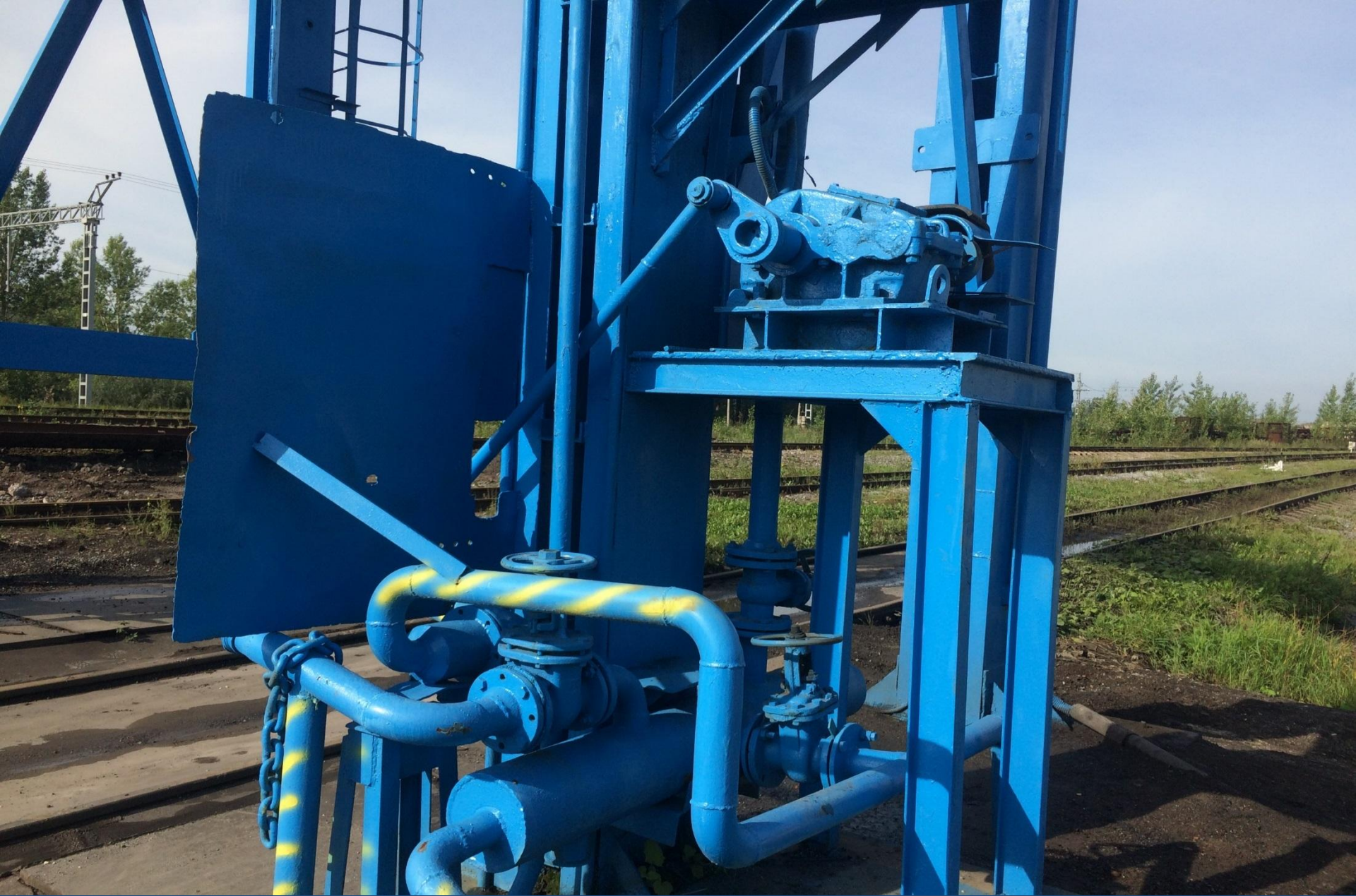
Рис. 4 - правый гидромонитор очистки вагонов.
