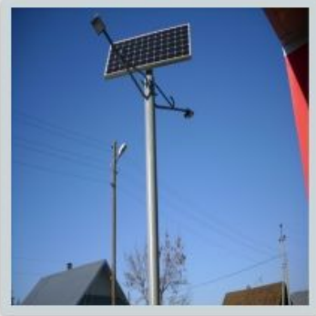
Уличный светильник на солнечных батареях (Детский сад, Саратовская область)
