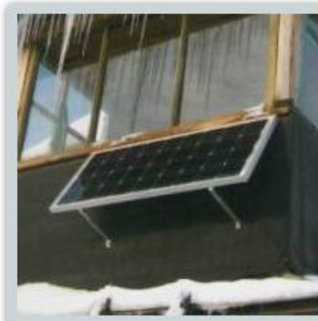
Солнечная энергетическая установка (пос. Мирный, г. Саратов)
