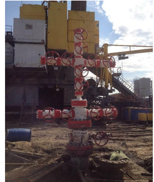
Фонтанная арматура скважины А
