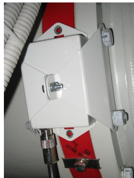
Датчик установлен на литнике распорки
