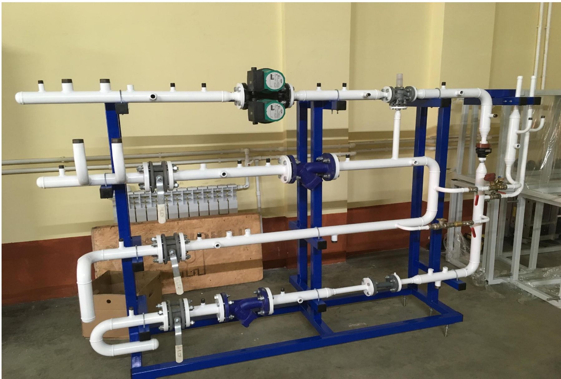
Фотография ИТП в цеху сборки
