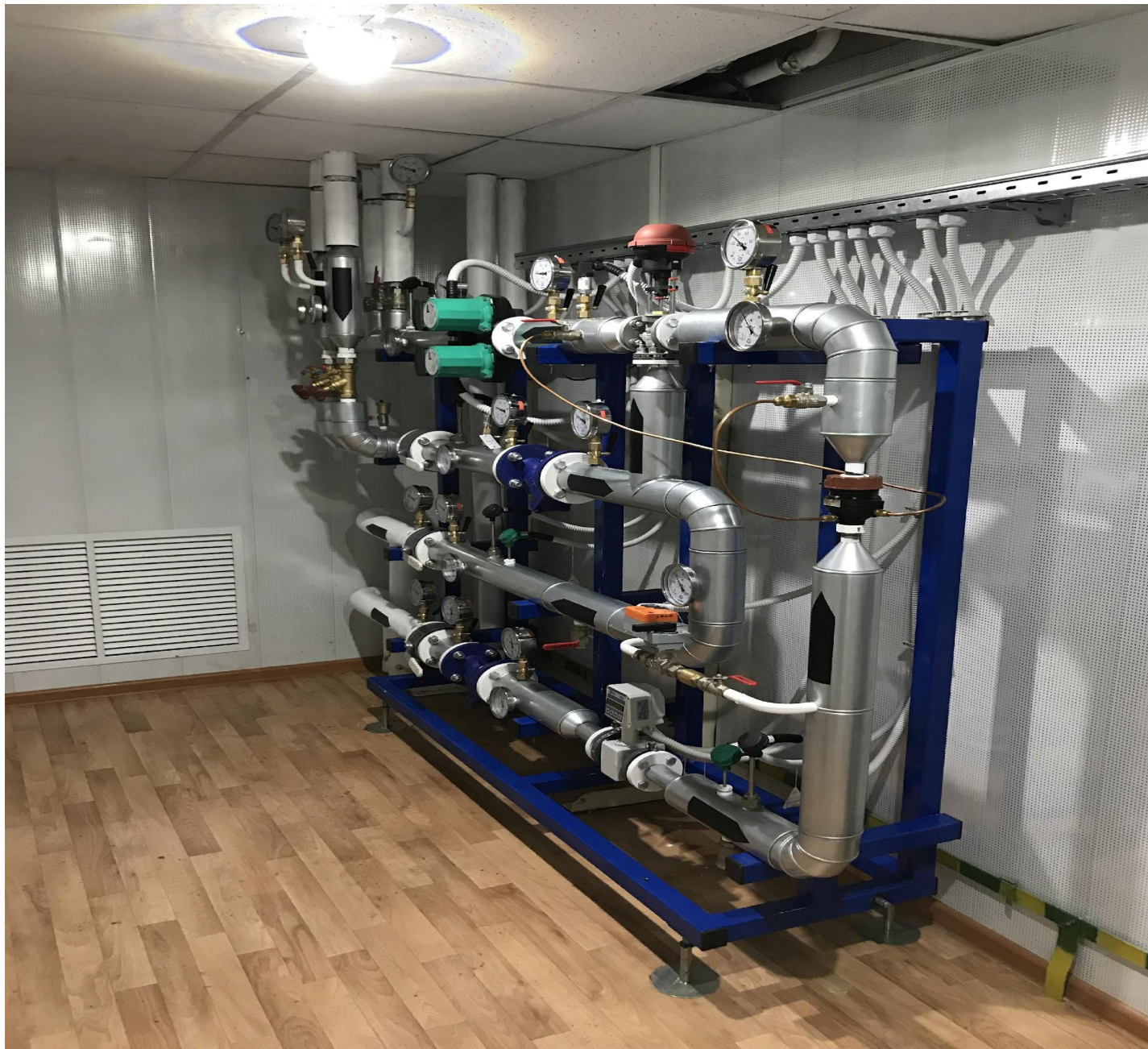
Фотография смонтированного ИТП на объекте
