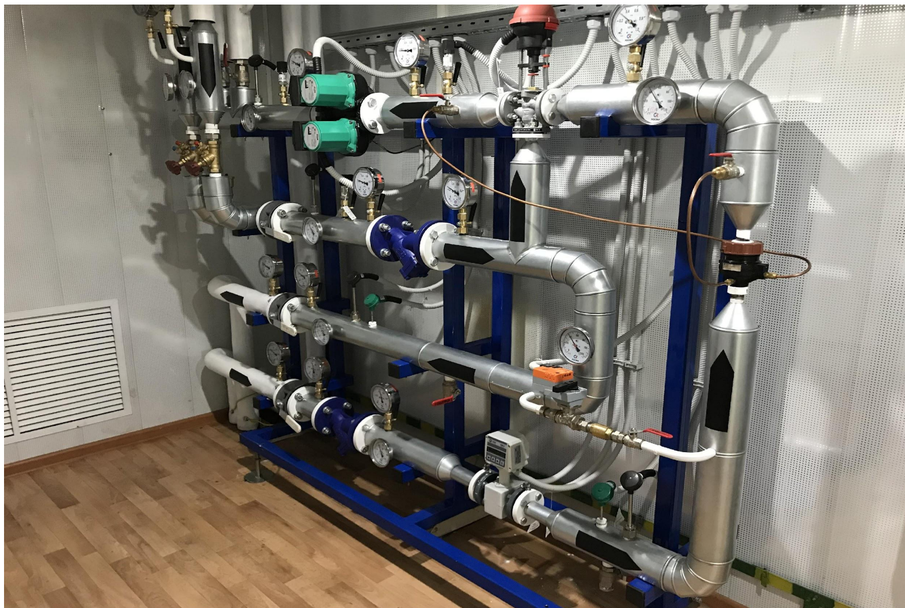
Фотография смонтированного ИТП на объекте
