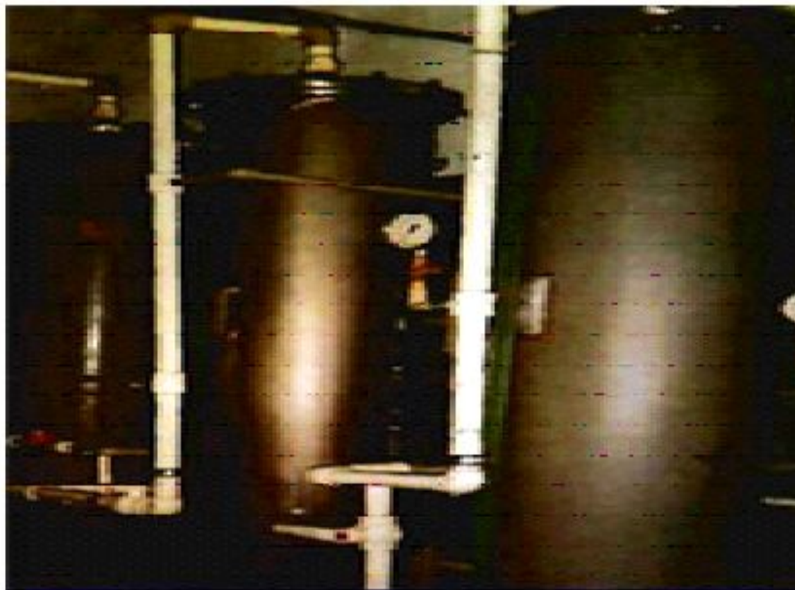
Установка очистки подземных вод с азрационным обезжелезиванием
