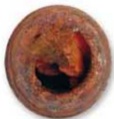
Коррозия труб без обработки воды
