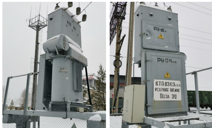
Состояние объекта до проведенных мероприятий (фото)
