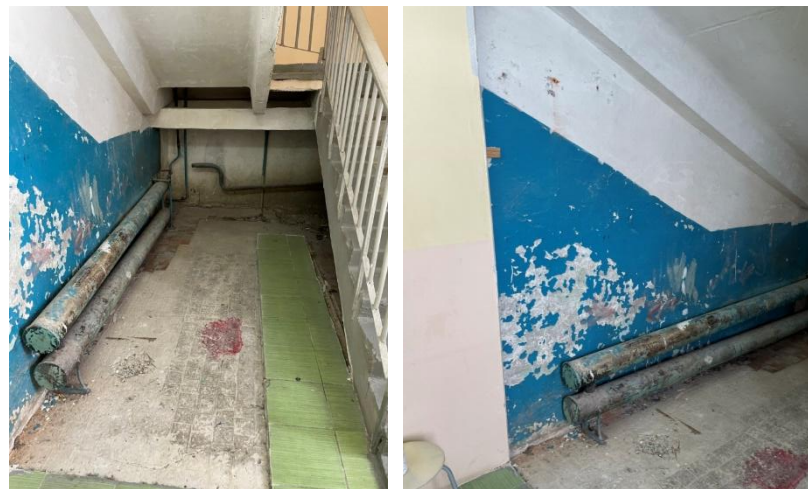
Состояние объекта до проведенных мероприятий (фото)
