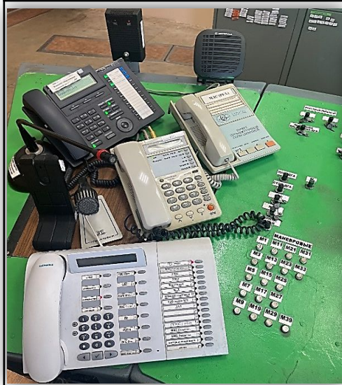
Состояние объекта до проведенных мероприятий (фото)
