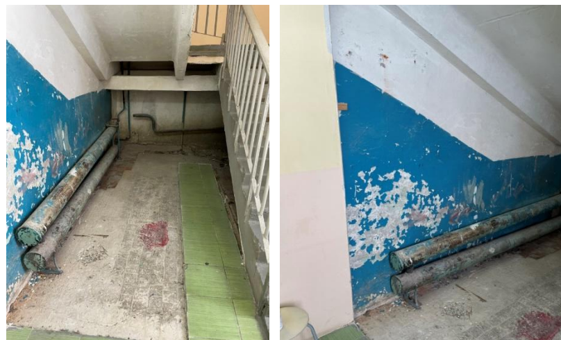
Состояние объекта до проведенных мероприятий (фото)
