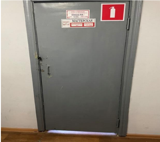
Состояние объекта до проведенных мероприятий (фото)
