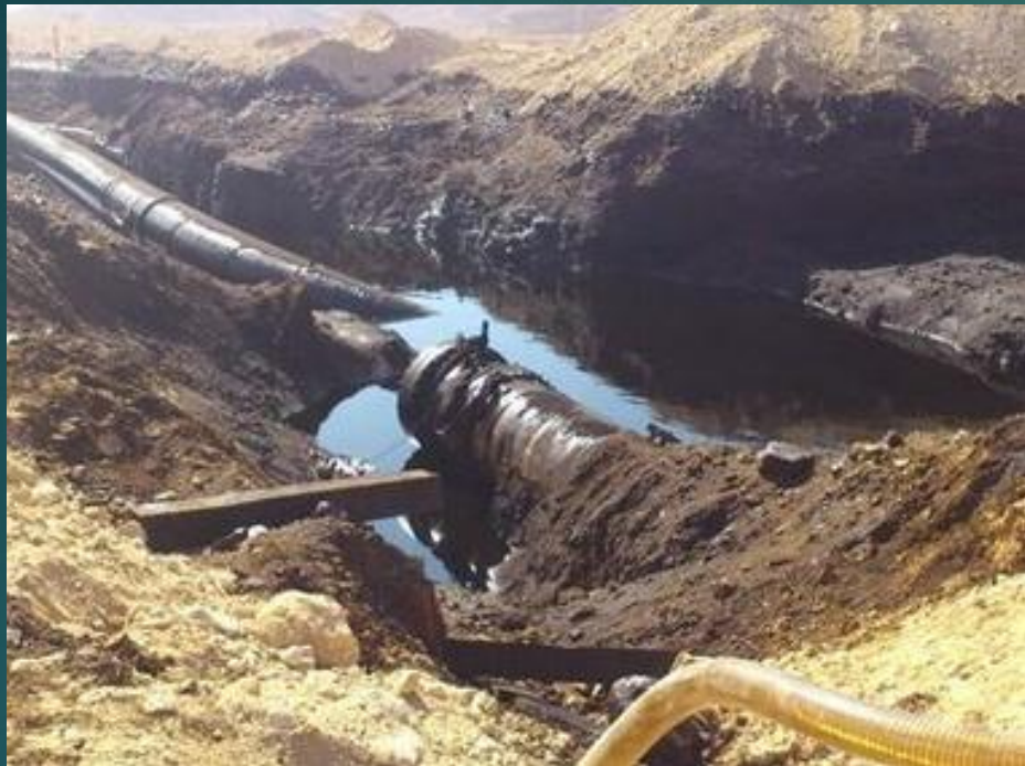
Авария произошла на нефтепроводе "Эйлат – Ашкелон"
