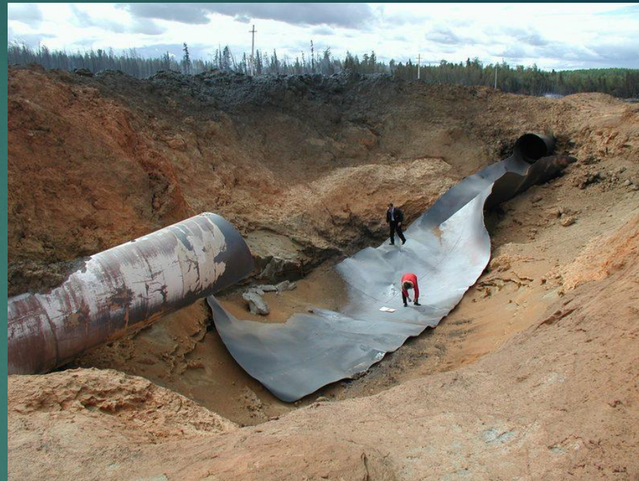
Разрыв газопровода на трассе Ухта-Торжок
