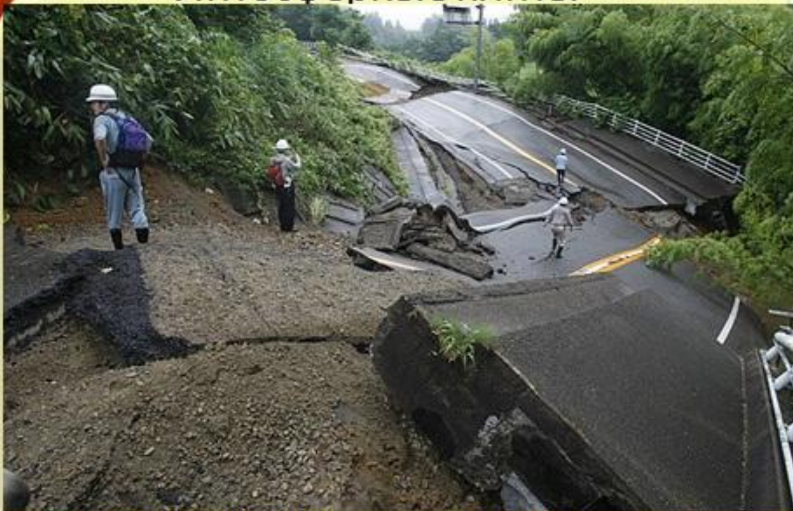
Смещение плит при землетрясениях
