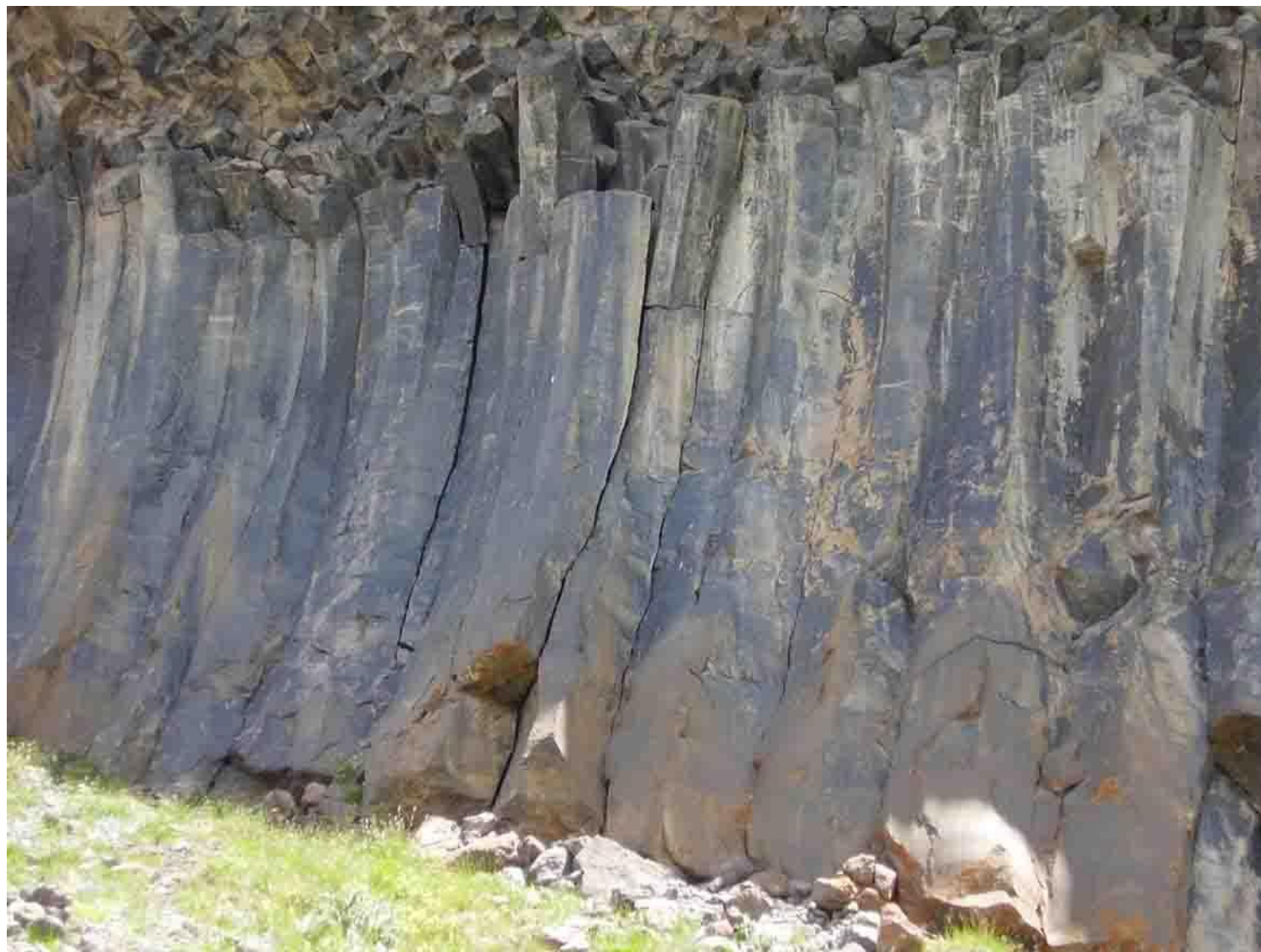
Разрушение базальтовых столбов на склонах Эльбруса
