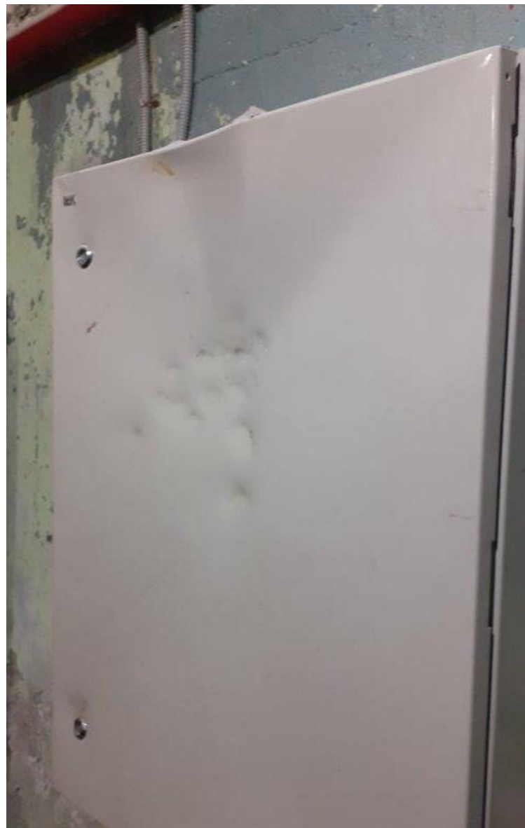
Поврежденный электрощит, не имеющий обозначений.
