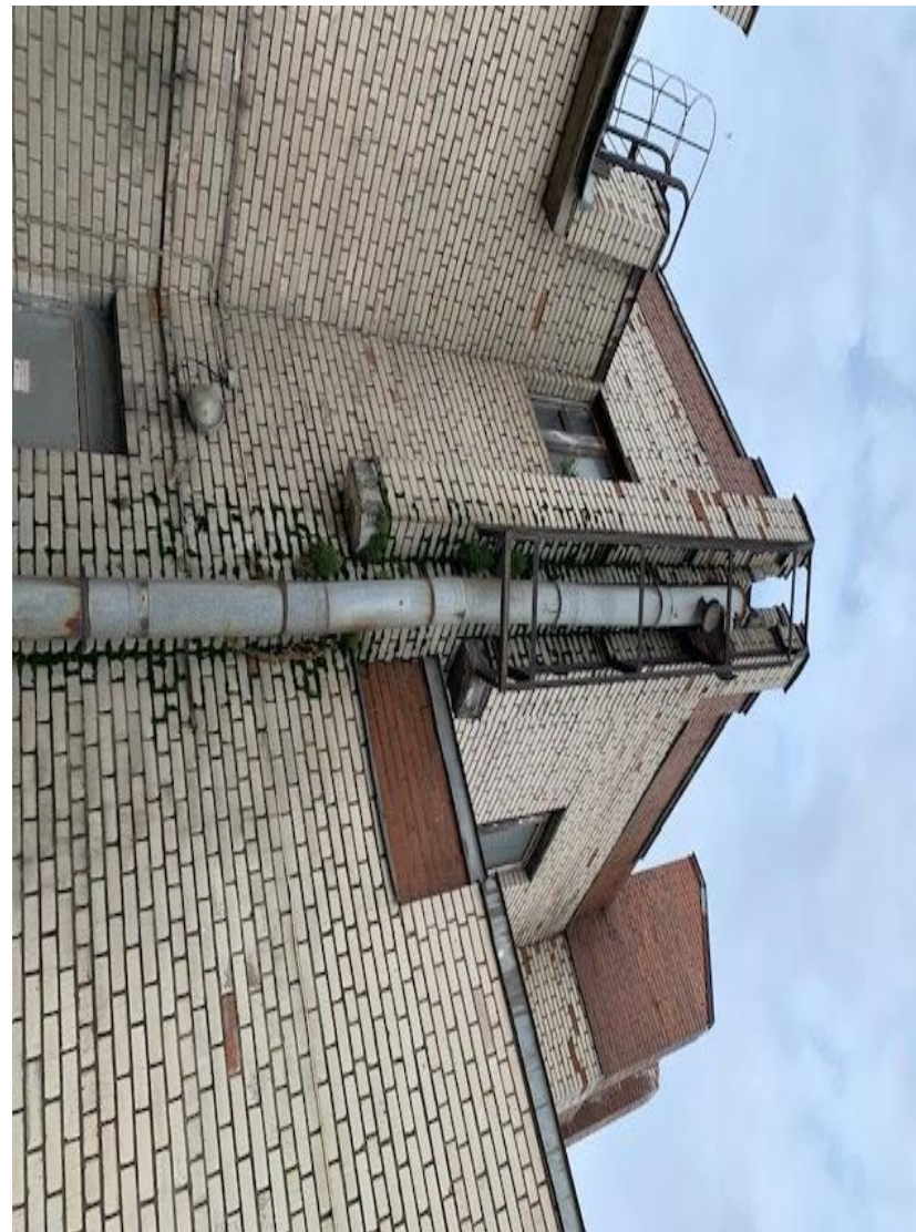
Сломанная водосточная труба
