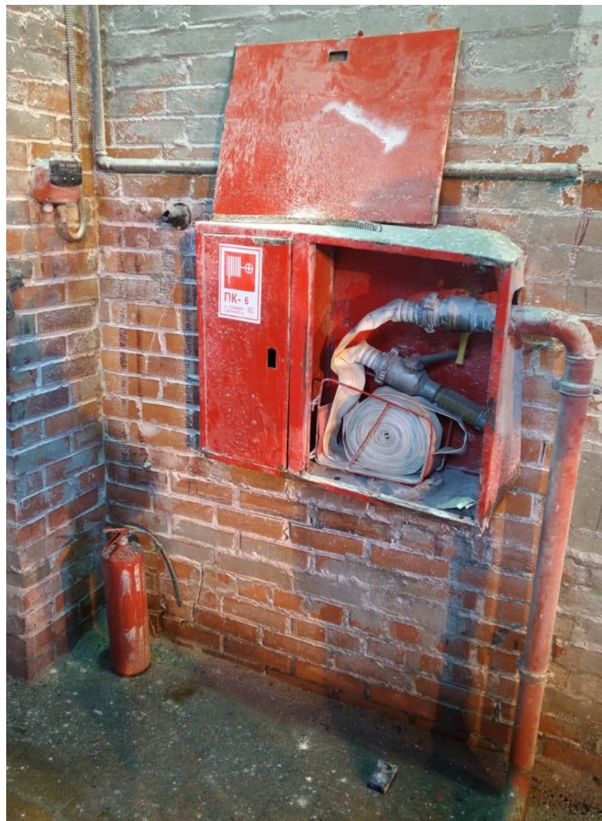
Неудовлетворительное состояние пожарного шкафа.
