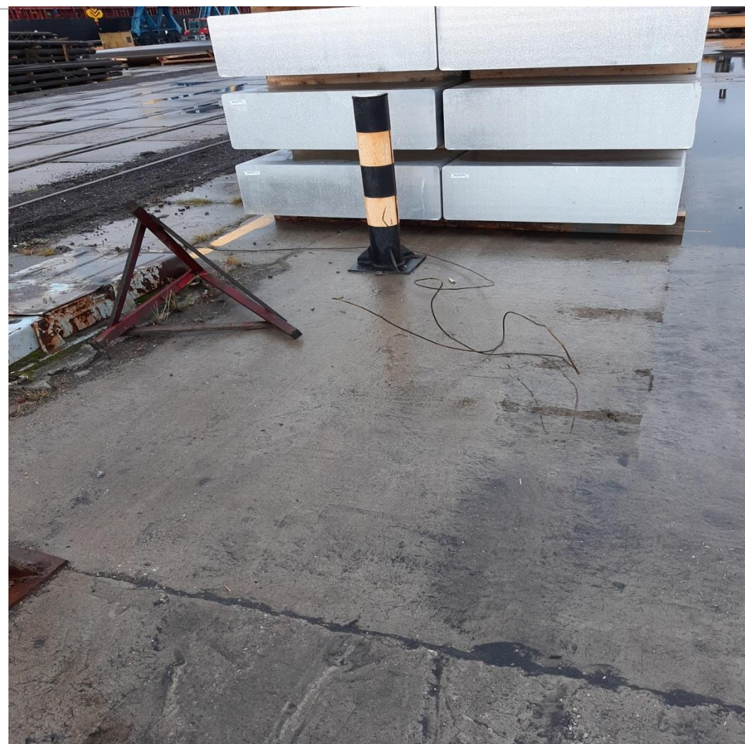
В тыловой части причала № 5 брошена проволока.
