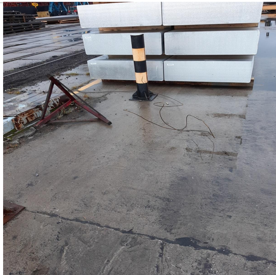
В тыловой части причала № 5 брошена проволока.
