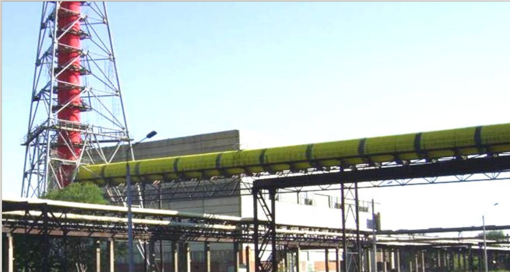
Трехслойный стеклопластиковый газоход диаметром 2.8 м на Чепецком механическом заводе (г. Глазов, Удмуртия)
