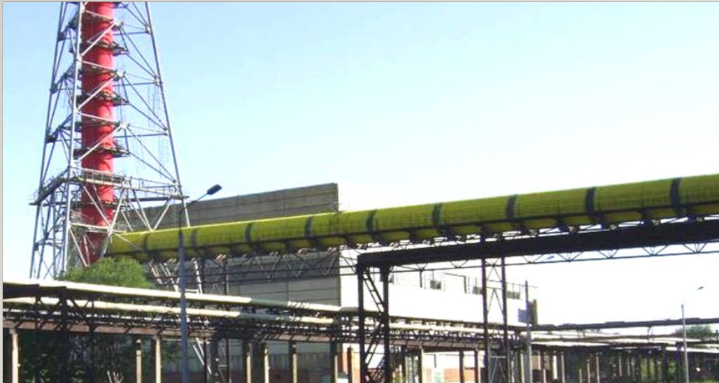
Трехслойный стеклопластиковый газоход диаметром 2.8 м на Чепецком механическом заводе (г. Глазов, Удмуртия)
