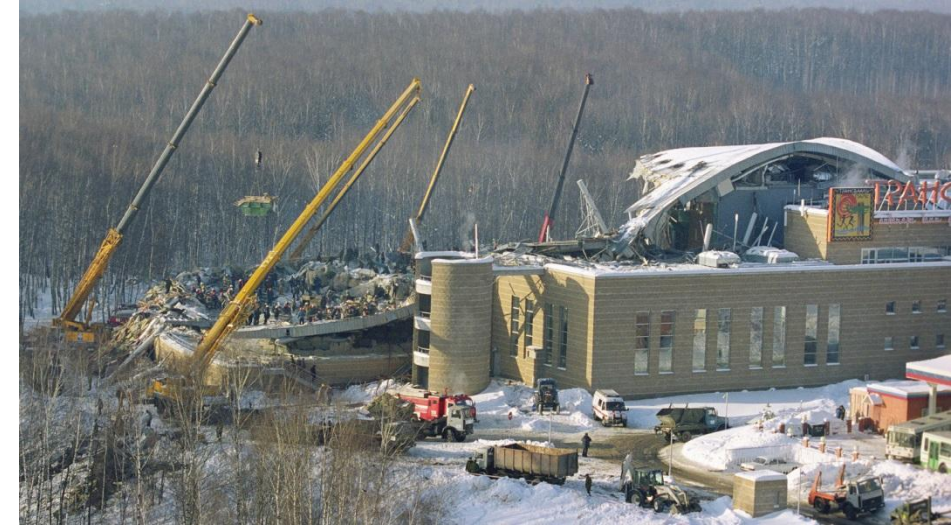
Обрушение покрытия Трансвааль-парка спустя 2 года после открытия, 2004 год, Москва
