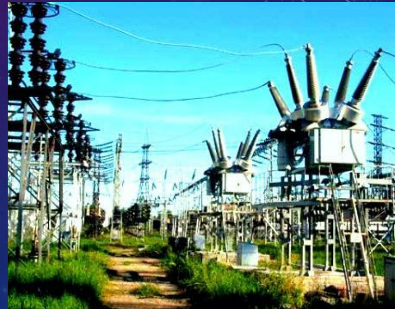
Не действующая электроустановка
