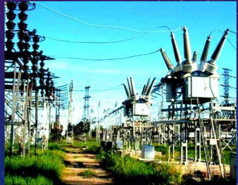
Не действующая электроустановка
