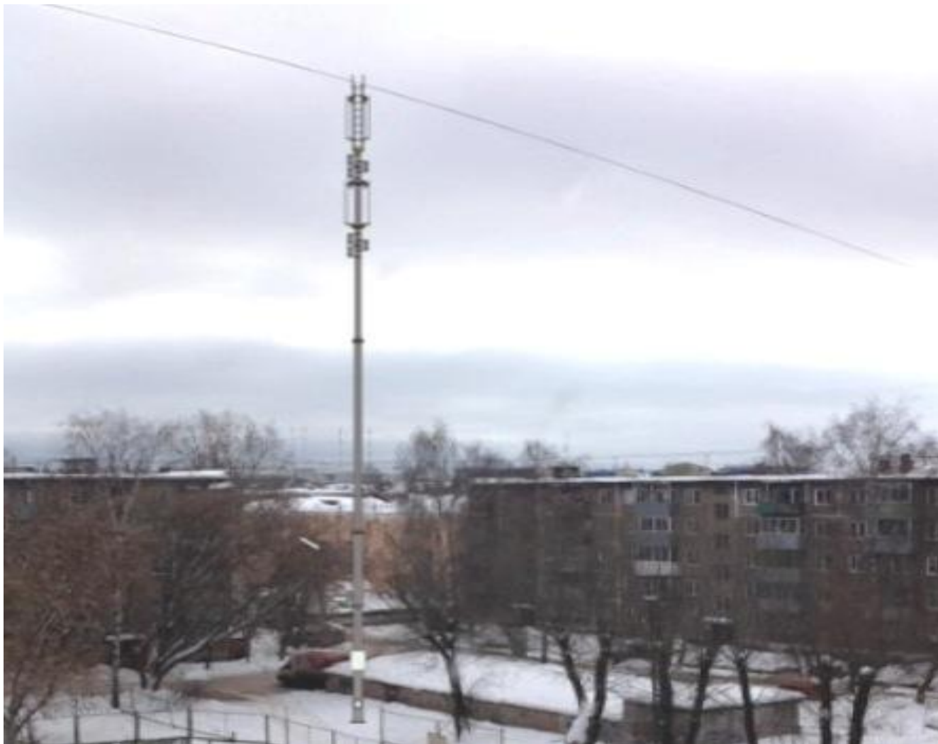
Металлическая многофункциональная опора Н=21-30 м
