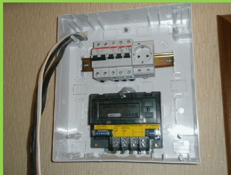
Пробная сборка щита без коммутации
