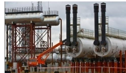
Производство полипропилена, компания «СИБУР»
