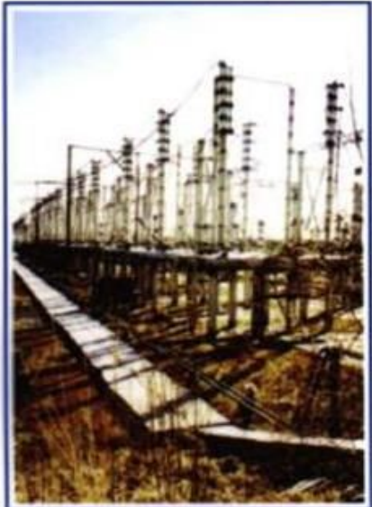
РУ с воздушными выключателями
