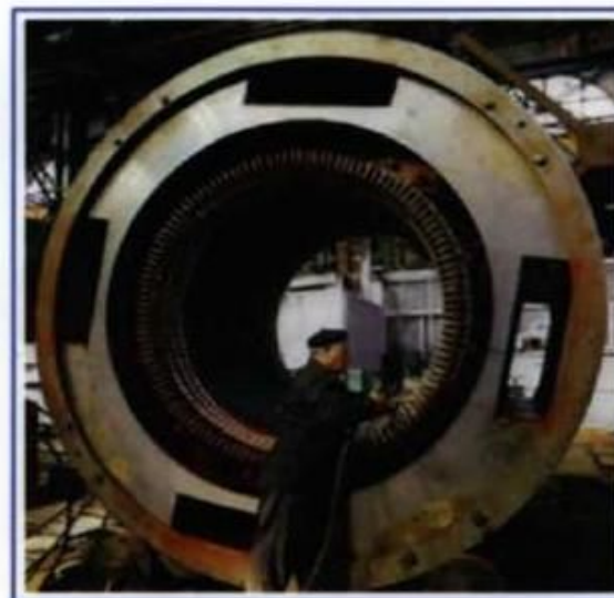
Обмотки электрических машин
