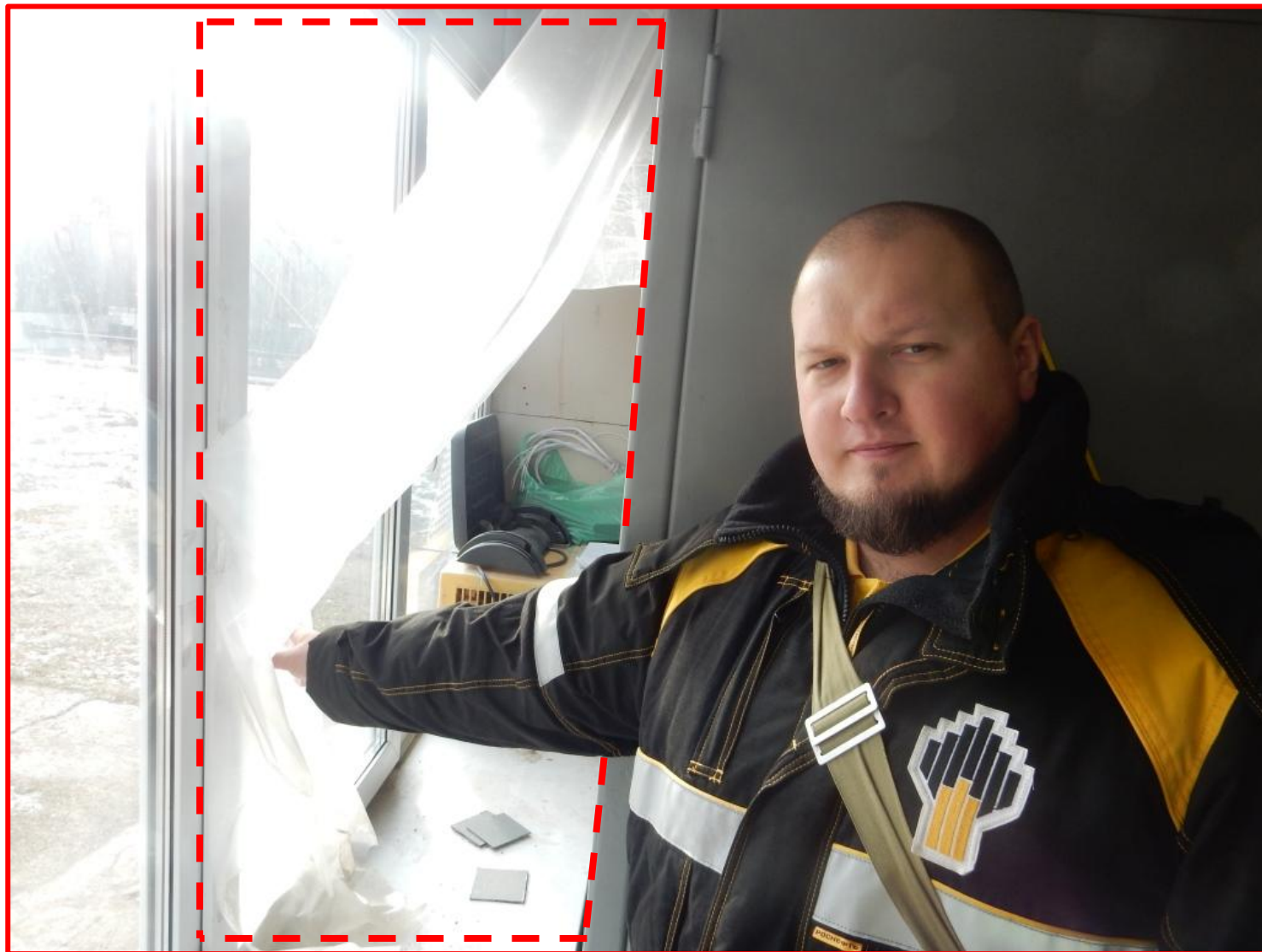
ФОТО № 11. Центральное реагентное хозяйство, цех №17 Не ограничен доступ за ЩИТ КИПиА в помещении операторной.
