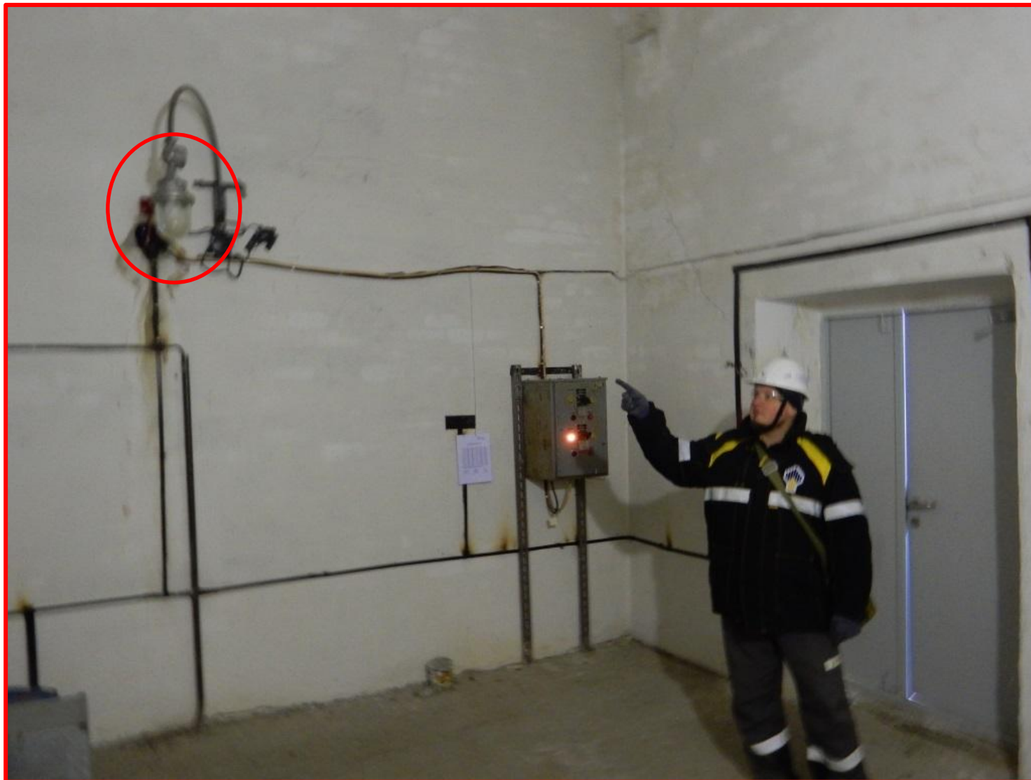
ФОТО № 15. Центральное реагентное хозяйство, цех №17 Неисправное освещение в ПВК.
