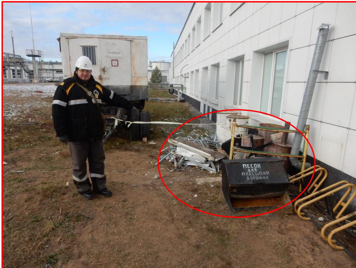
ФОТО № 9. Центральное реагентное хозяйство, цех №17 Мусор, посторонние предметы с северной стороны АБК цеха №17.
