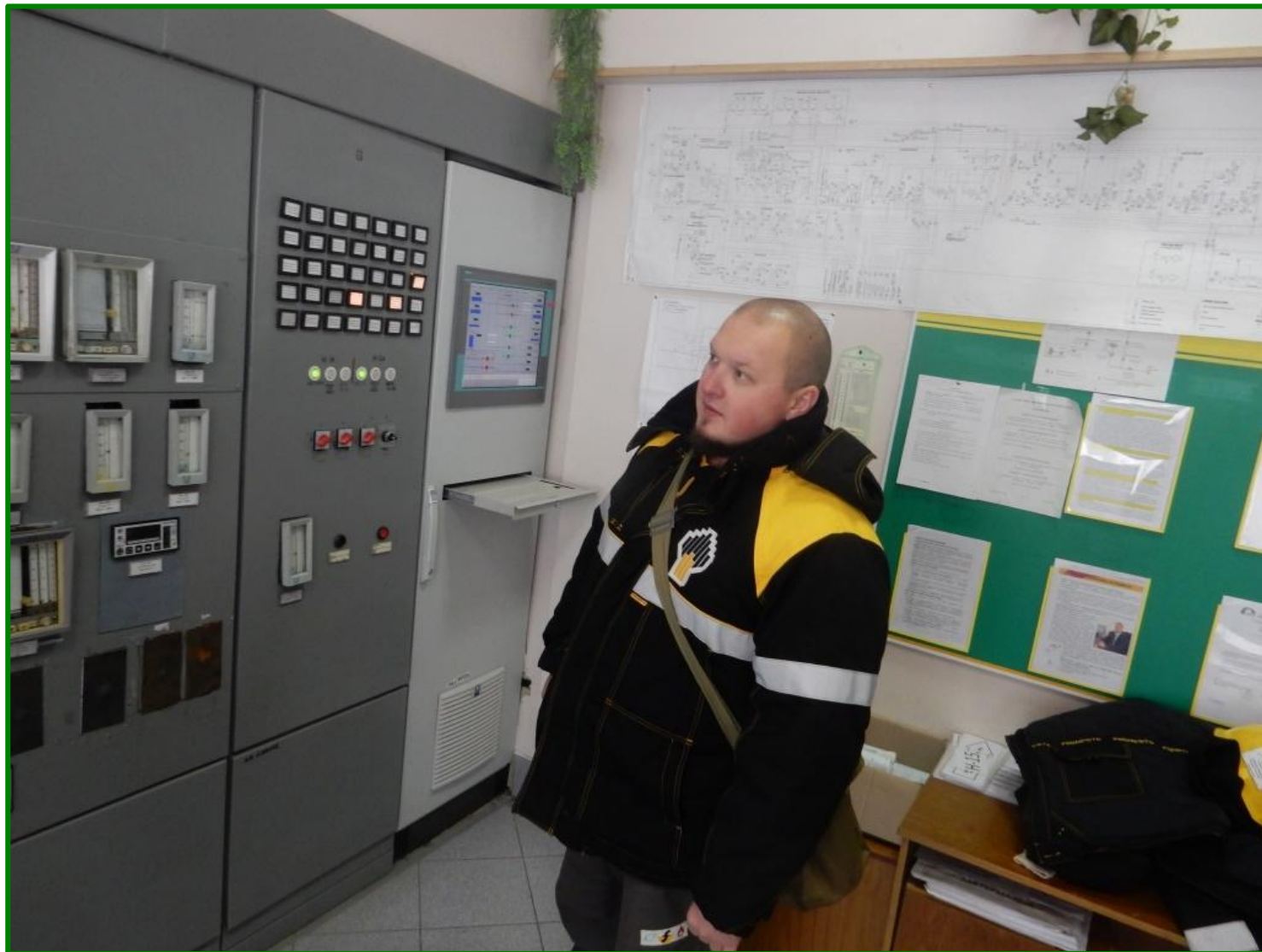
ФОТО № 6. Центральное реагентное хозяйство, цех №17 Системы блокировок, сигнализации и противоаварийной защиты исправны и включены в работу.
