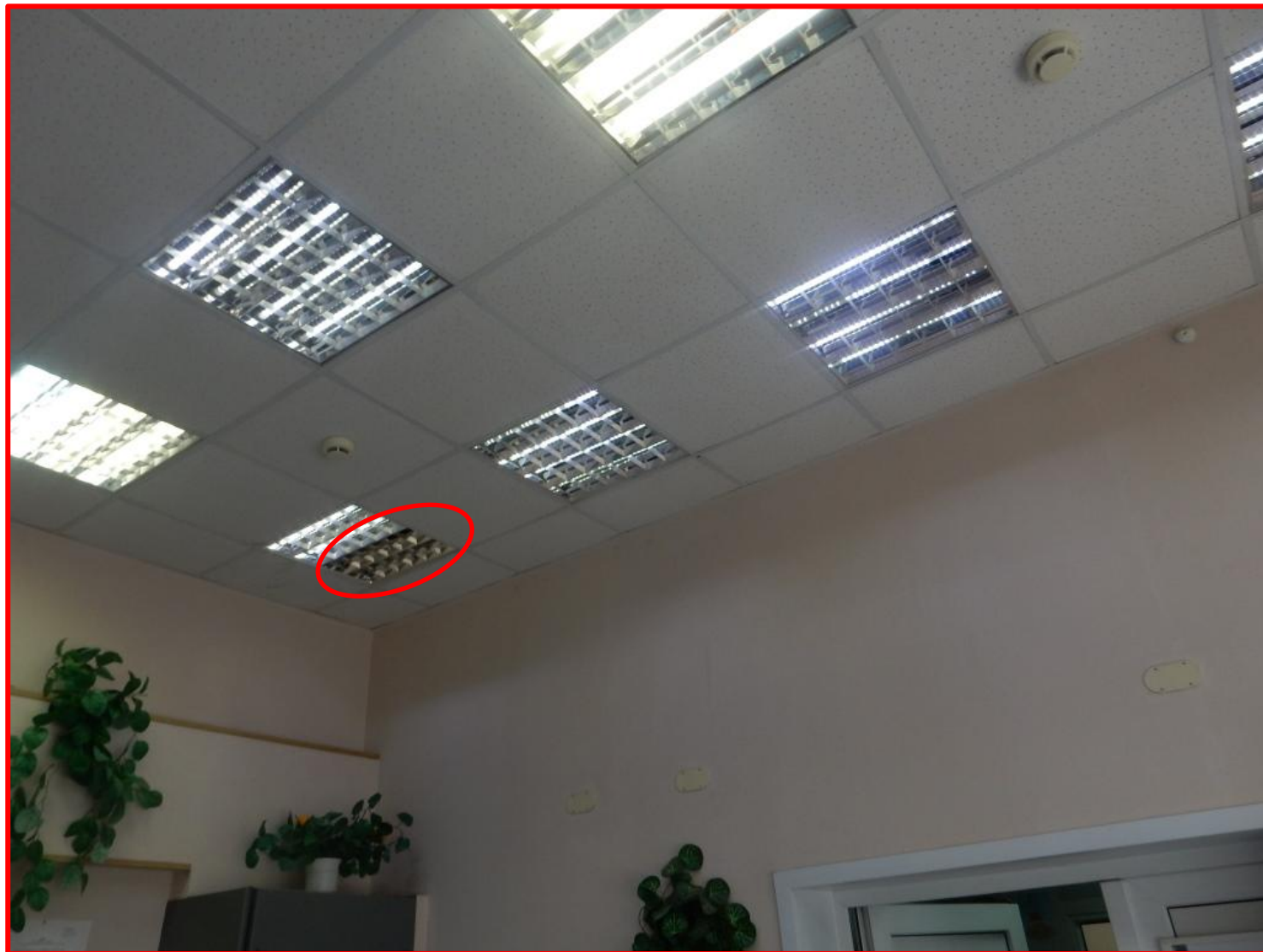
ФОТО № 12. Центральное реагентное хозяйство, цех №17 Неисправное освещение в помещении операторной.
