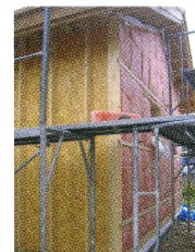
Метод теплоизоляции для внешних стен в 200 мм, позволяющих обеспечить значение Q не превышающее 1,3 \text{ Вт/м}^2 \times \text{К} .
