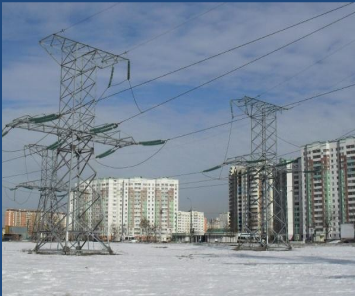
2 цепи ВЛ220кВ с грозозащитными тросами
