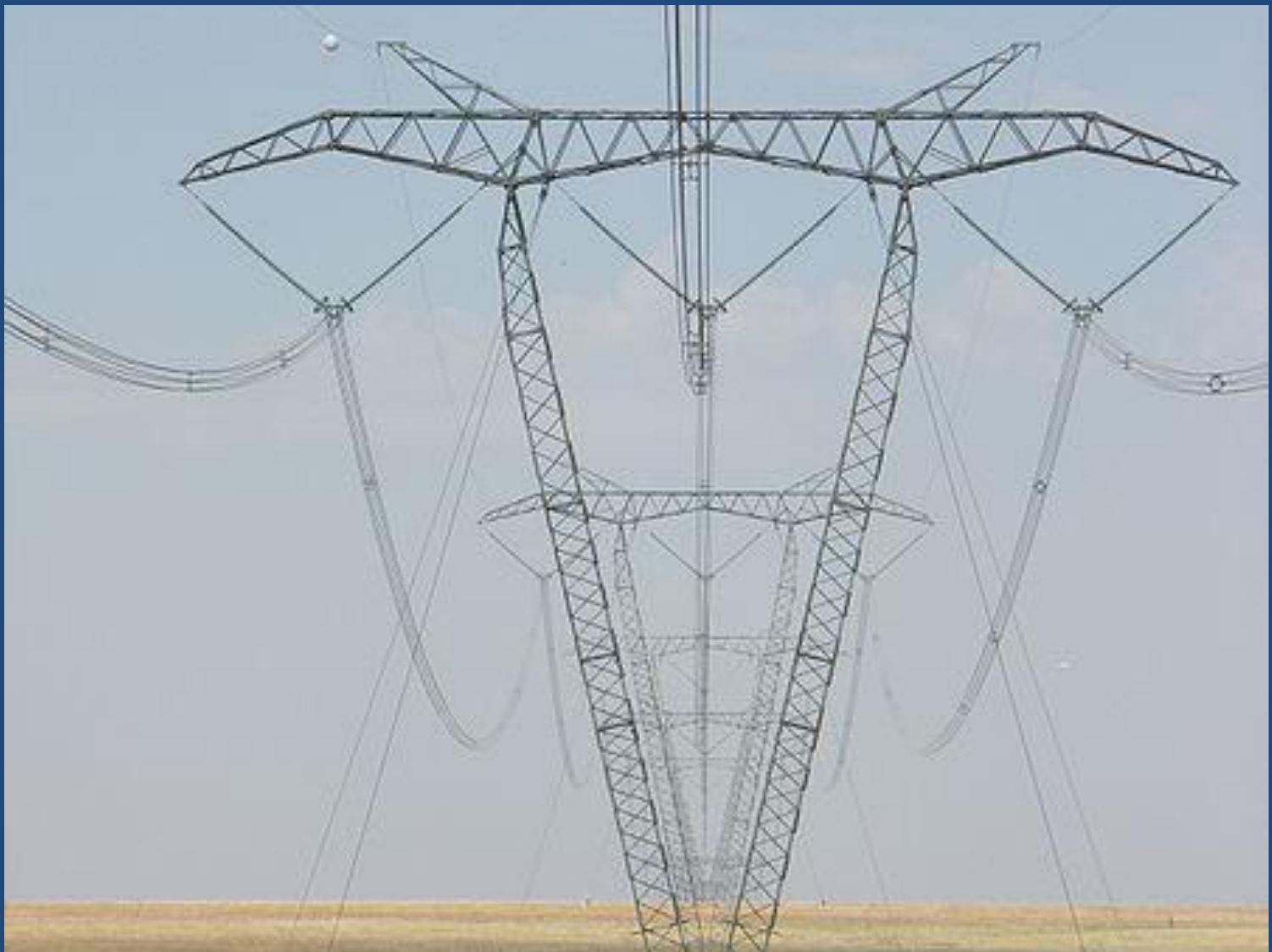
Качающиеся решетчатые металлические опоры ЛЭП СВН (Африка)
