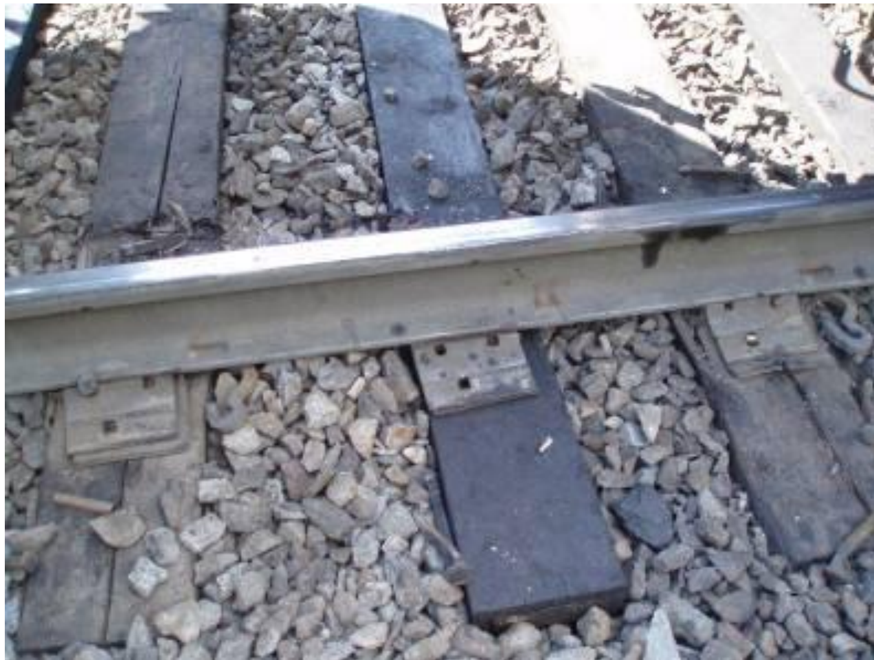
«Расшивка» пути, отсутствие костылей
