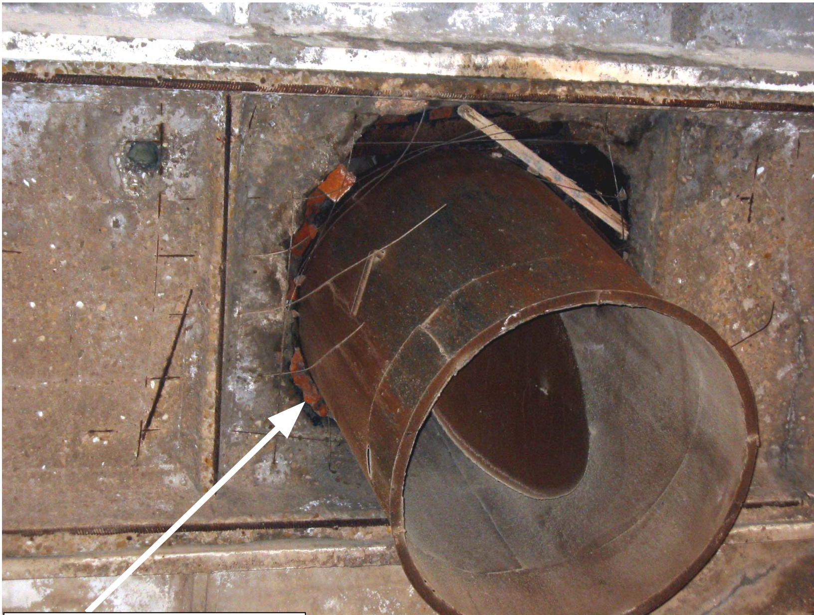
Сквозное отверстие в полке, обрывы арматуры полки, оголение арматуры полки
