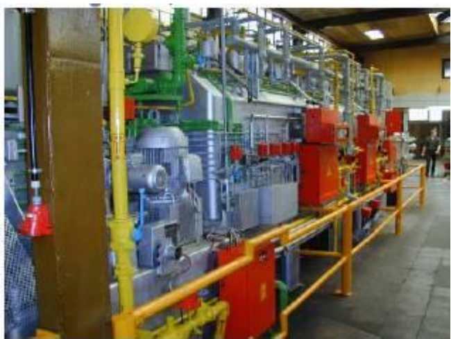
Коммуникации, блоки управления
