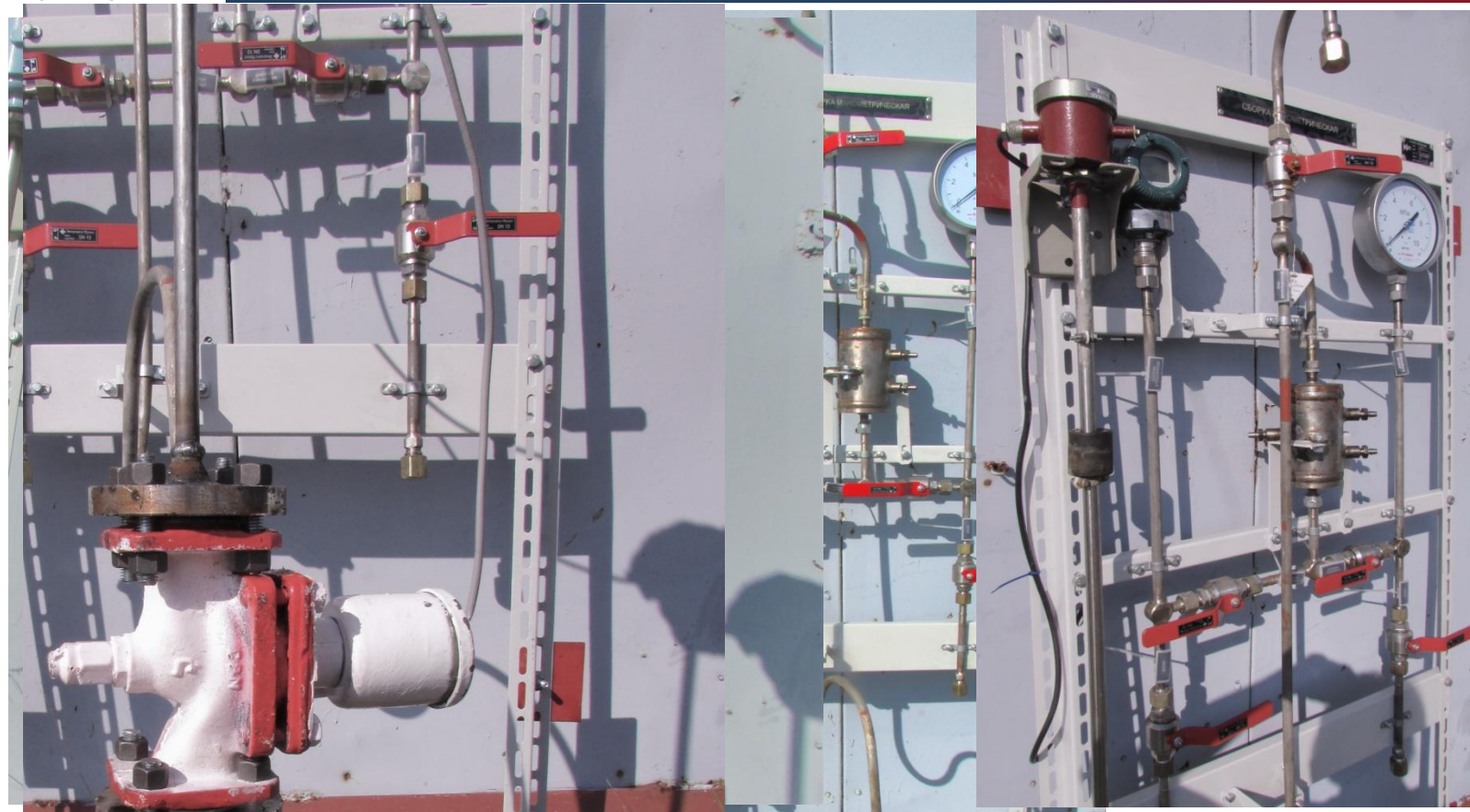
Разработка технических решений по защите от утечек нефти в колодцах отбора давления
