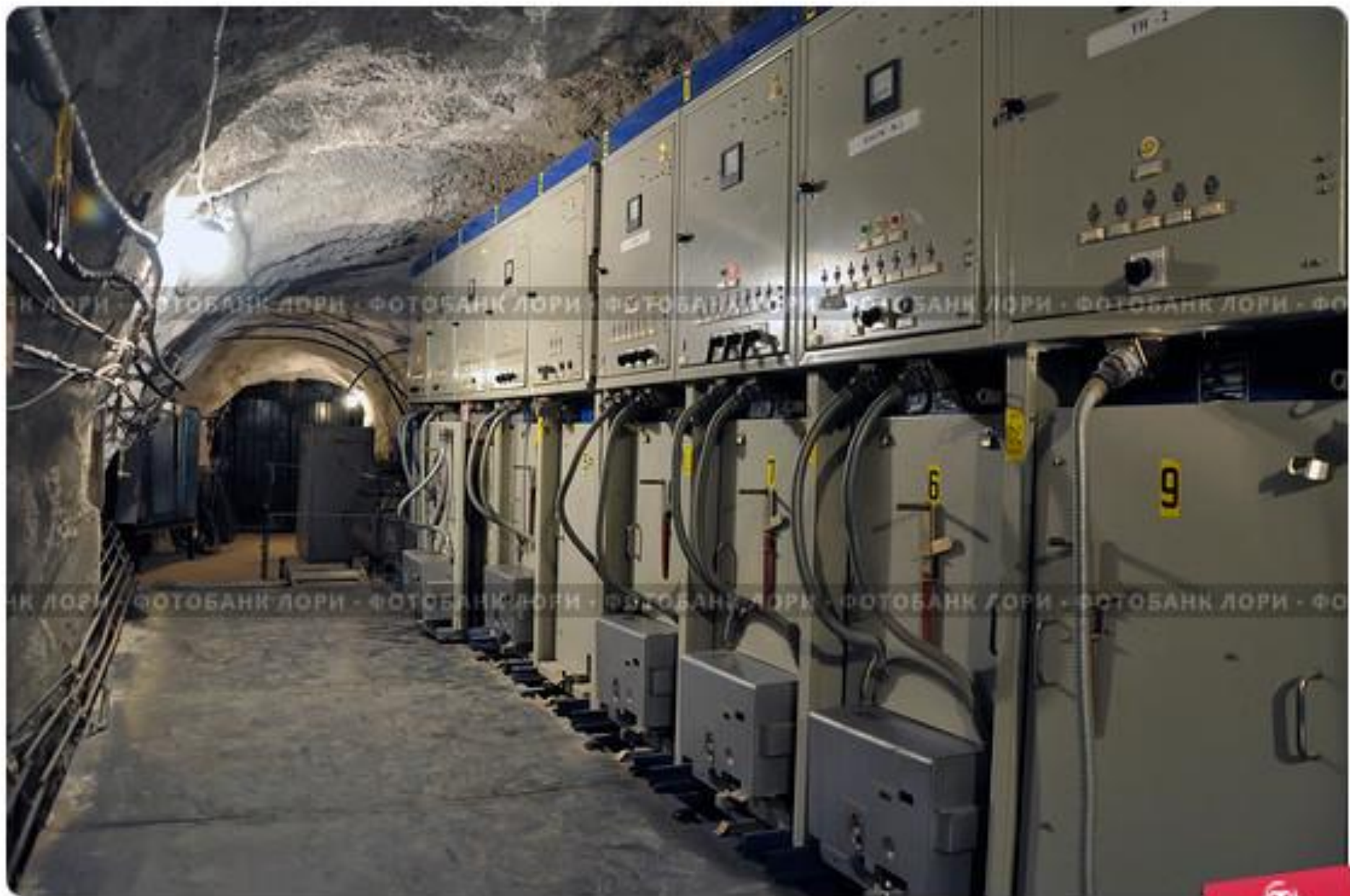
Распределительное устройство подземной трансформаторной подстанции
