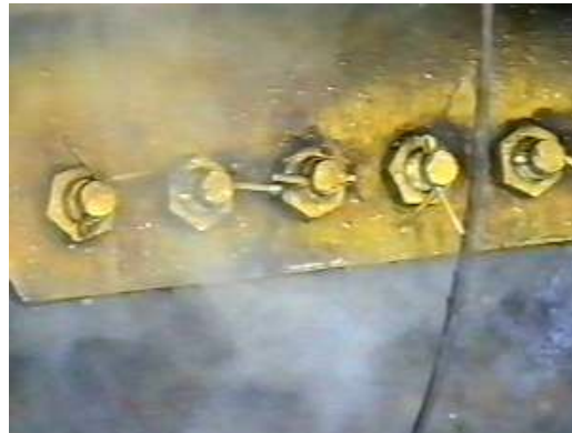
Узел крепления железнодорожной цистерны после очистки
