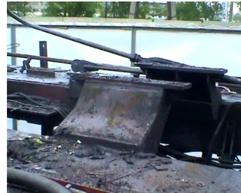
Узел технологического оборудования до очистки
