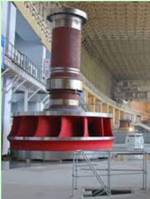
Рабочее колесо турбины Красноярской ГЭС
