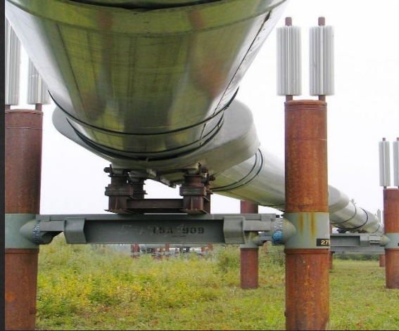
Наземный нефтепровод на Аляске
