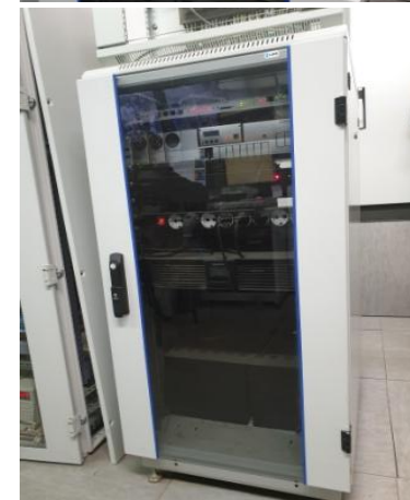
Шкафы АСУТП с информационно-измерительной системой
