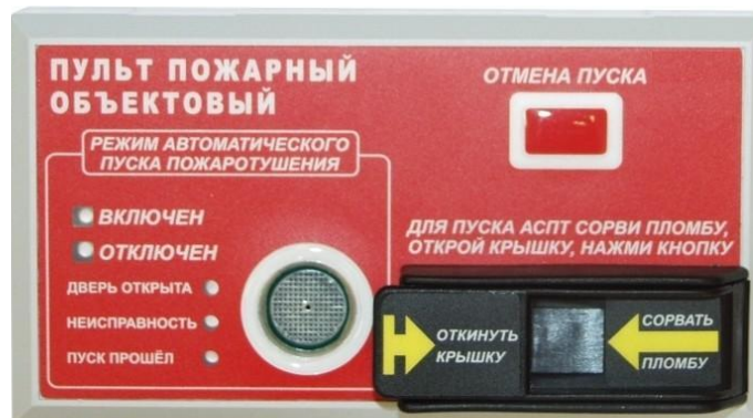
Пульт управления противопожарной системой стенда
