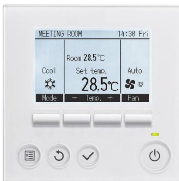
Пульт управления системой кондиционирования кабины наблюдения и управления
