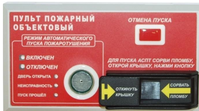
Пульт управления противопожарной системой стенда
