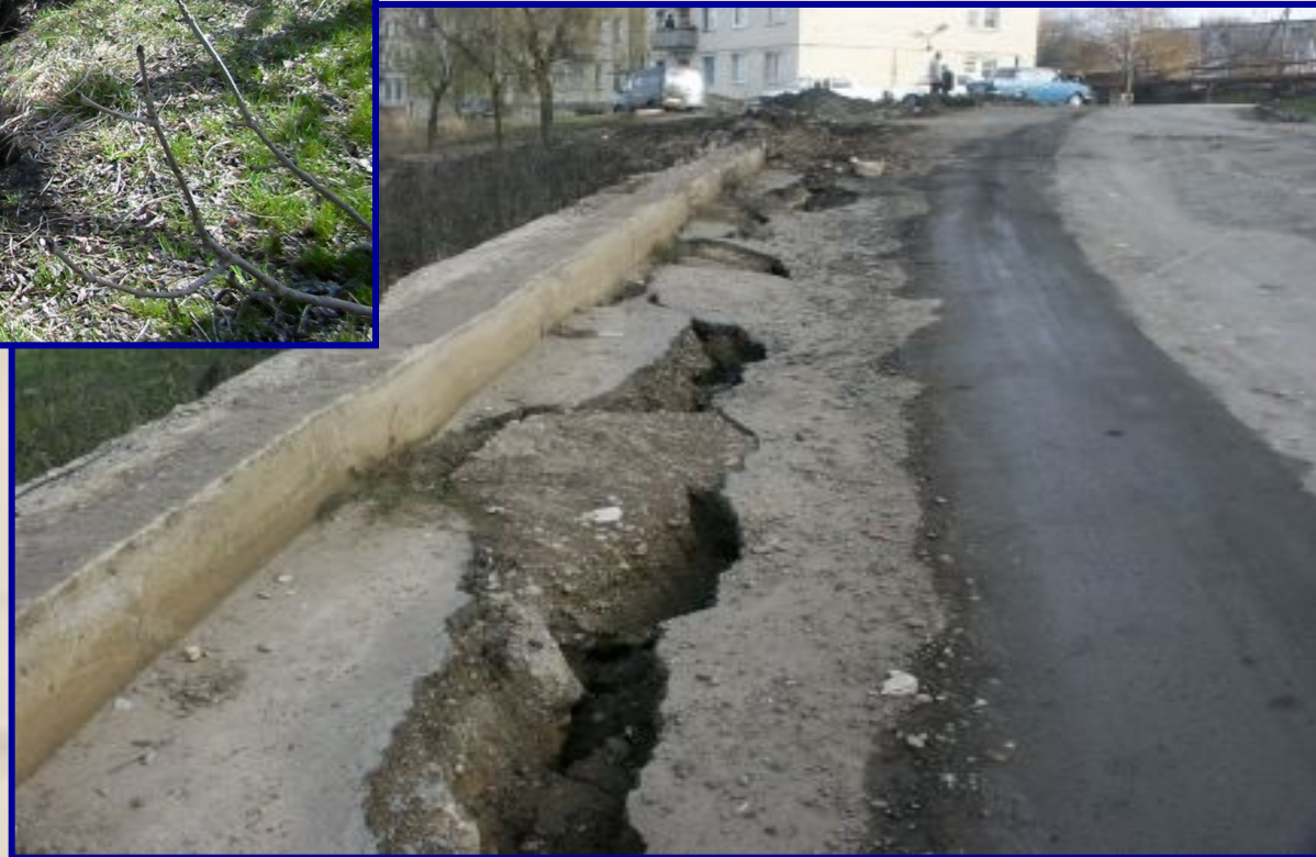
Разрушенный участок автодороги по ул. Трунова на Члинском оползневом участке г. Ставрополя.
