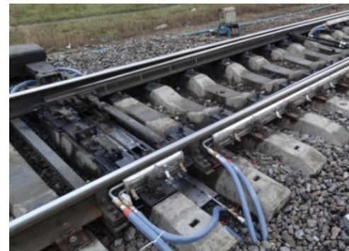
Система геотермического обогрева стрелочного перевода
