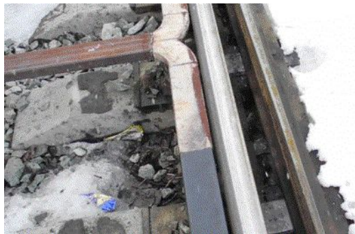
Система газообогрева на стрелочном переводе
