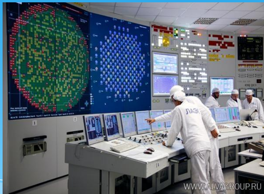
Ленинградская АЭС Блочный щит управления
