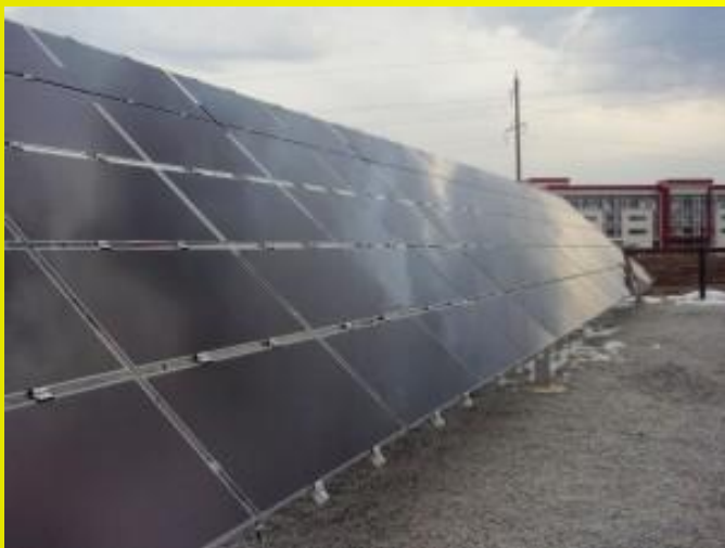
Солнечная электростанция в Белгородской области
