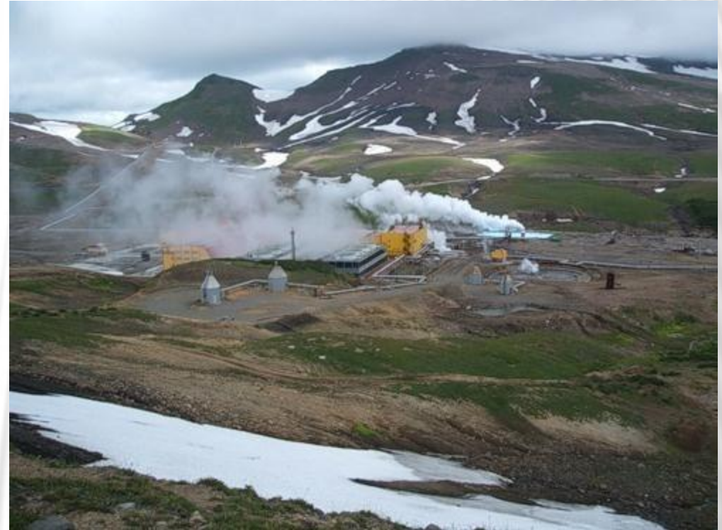
Мутновская геотермальная станция
