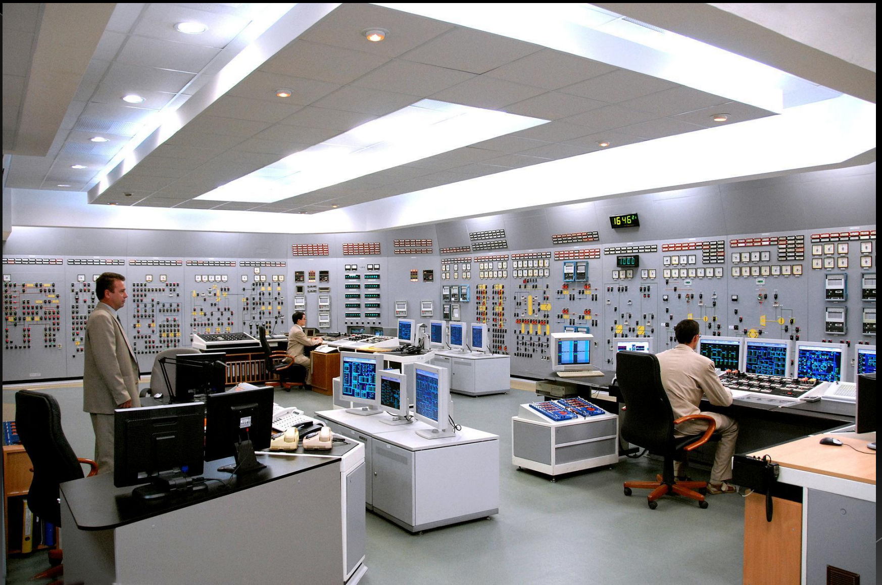
Блочный щит управления. За работой оперативный персонал: слева ведущий инженер по управлению реактором, справа — турбиной, позади них начальник смены блока.
