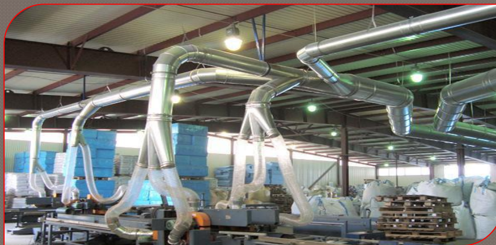
Вентиляция хлебопекарного цеха
