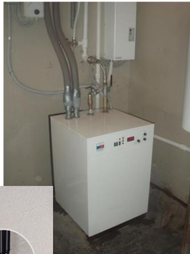
Площадь котельной 2 кв.м.
