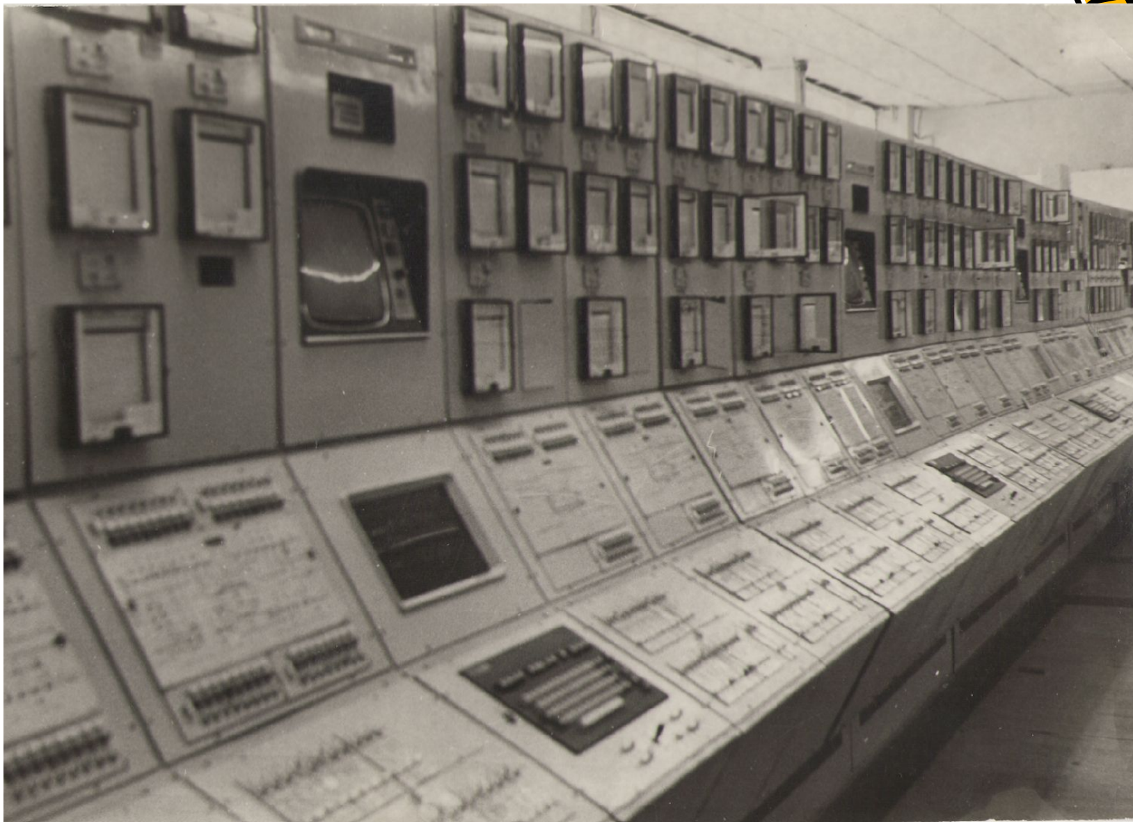
Центральный пульт управления (ЦПУ)
