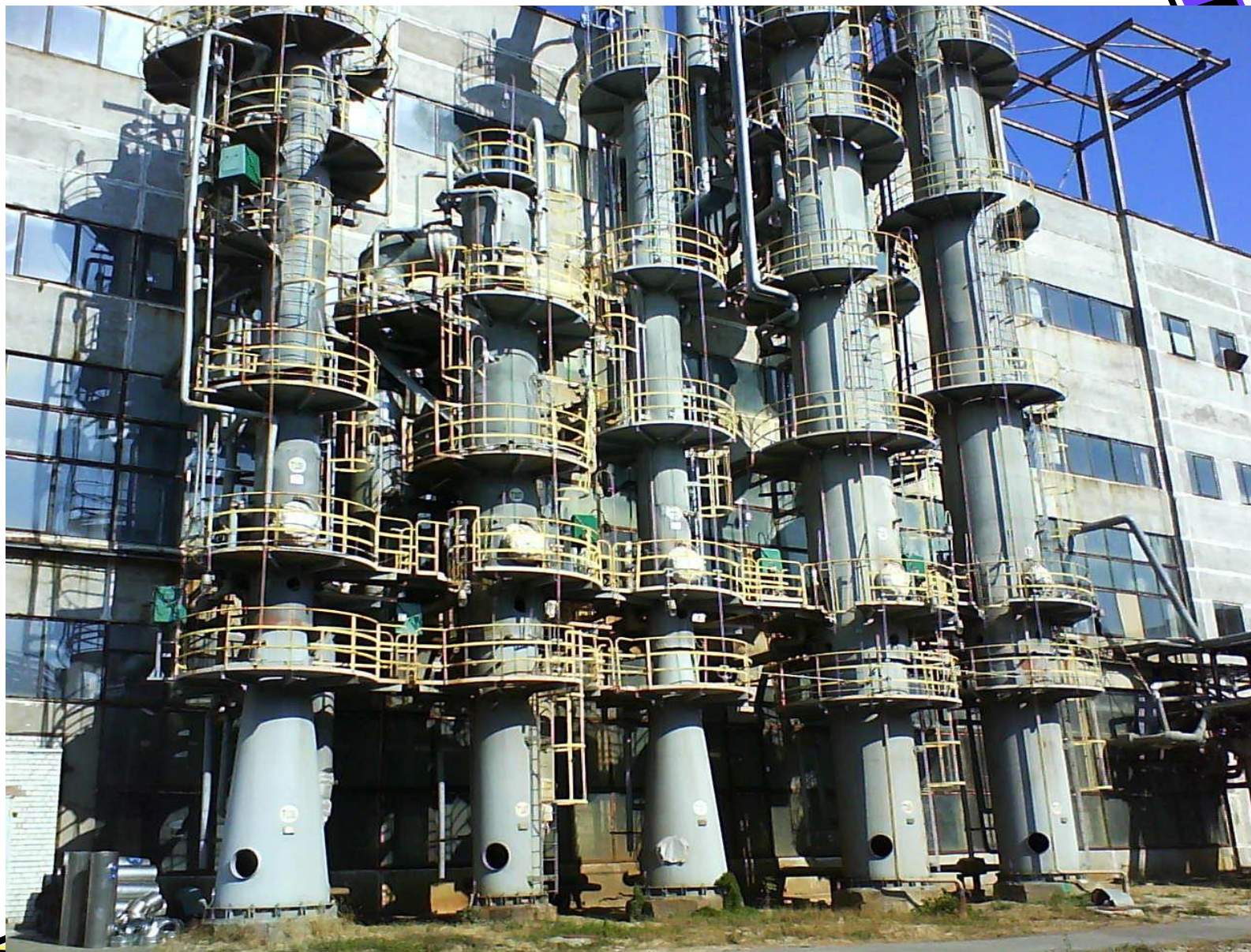
Наружные установки (колонны ректификации) на производстве акриловых соединений
