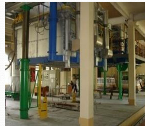
Обжиг деталей печь газовая Wistra1,2 (Германия)
