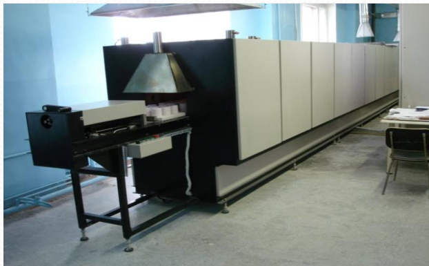
Оплавление глазури печь электрическая GMQ 4030-15 NM (Китай)
