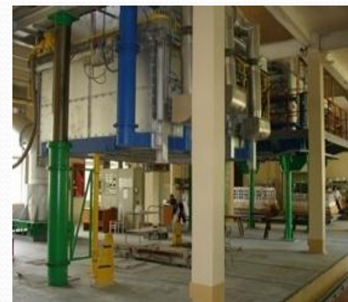
Обжиг деталей печь газовая Wistra1,2 (Германия)
