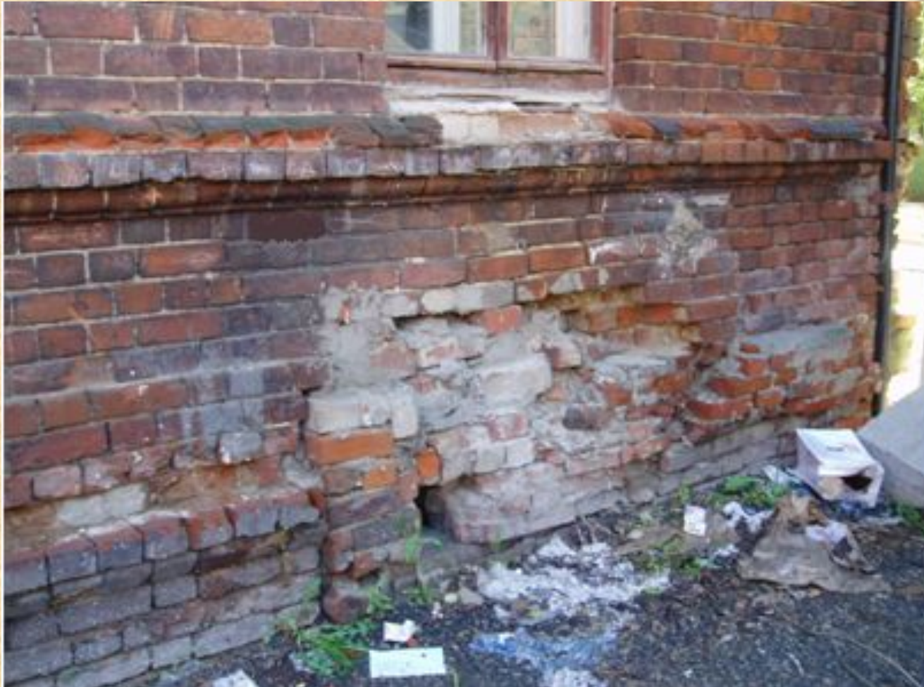
Рис. 4.4. Разрушение каменной кладки (лицей в г. Томске)
