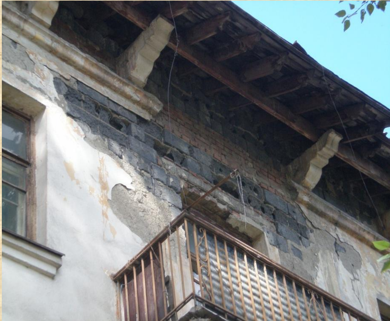
Рис. 4.5. Замачивание каменной кладки (жилой дом по ул. Римского-Корсакого)
