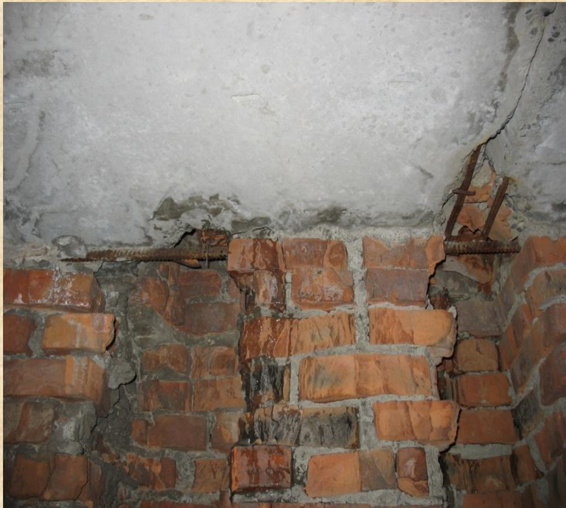
Рис. 4.3. Размораживание каменной кладки (гостиница в г. Горно-Алтайск)
