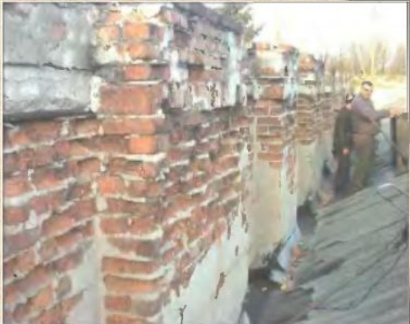
Рис. 4.1. Разрушение карнизной части кирпичной стены школы искусств в Донецкой области
