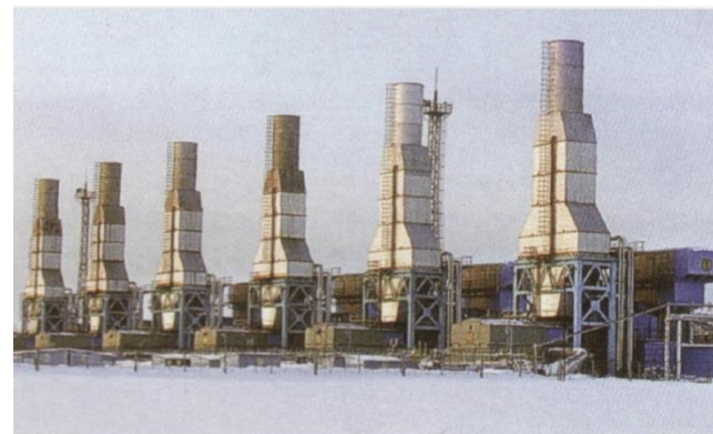
Агрегаты ГПА-Ц-16С с двигателем UGT 15000 на компрессорной станции "ДКС-4 Ямбурггаздобыча", Россия
