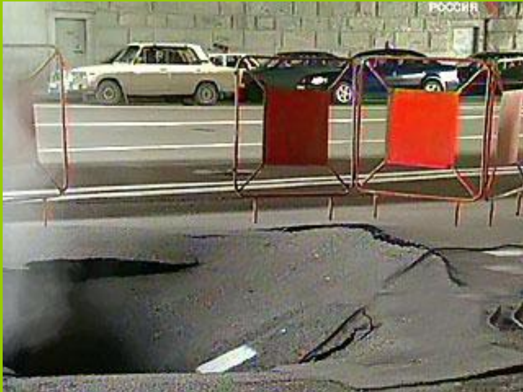
Провал грунта на ул. Косыгина в Москве
