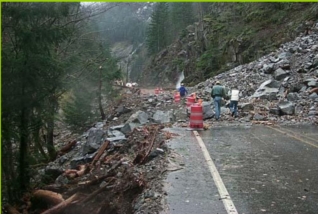
Обвал, заваливший горную дорогу, США, 2003 г.
