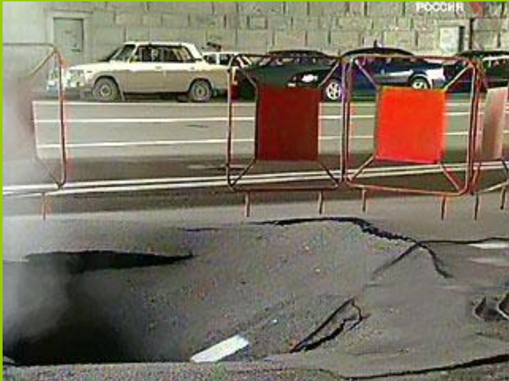
Провал грунта на ул. Косыгина в Москве
