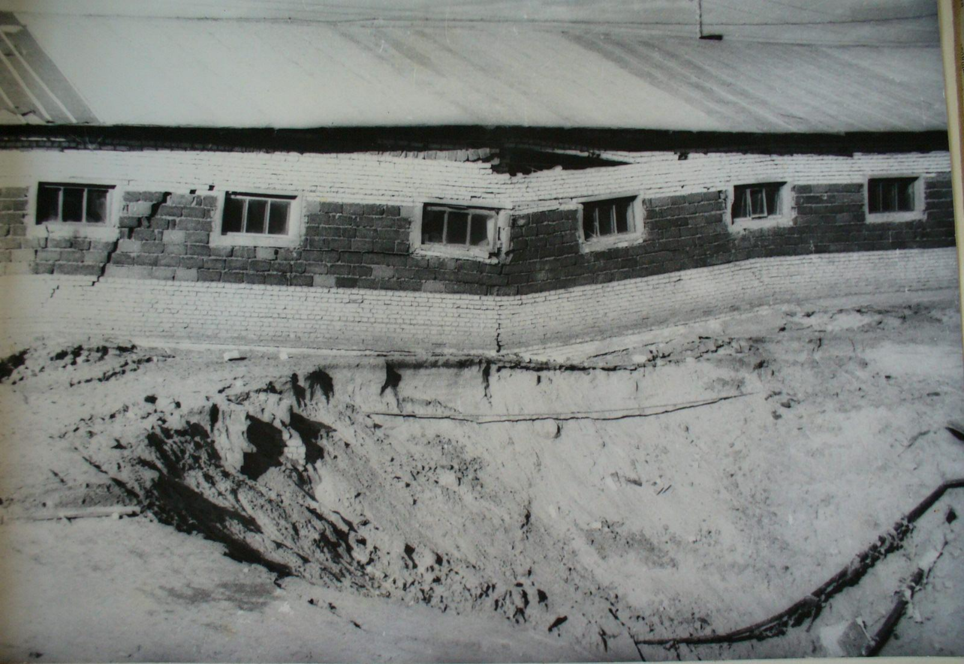
Провал на стройбазе Дзержинской ТЭЦ ( 5.09.61г.Диаметр 26,0м )
