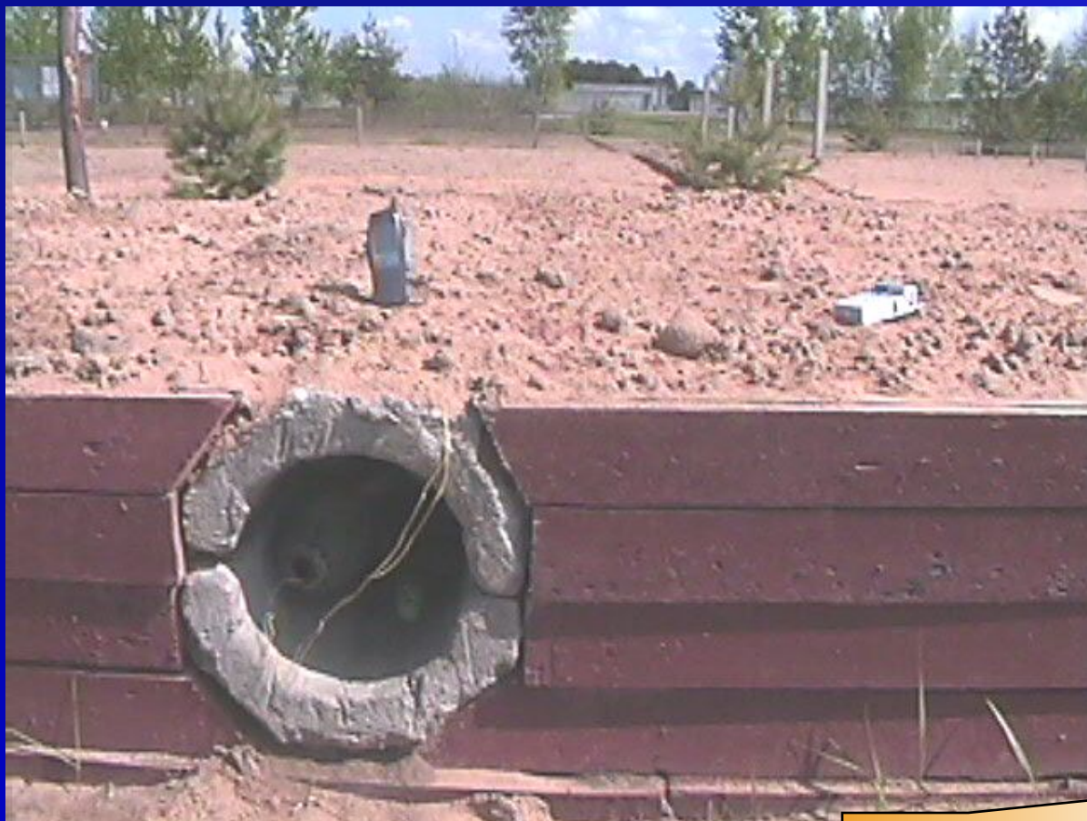
Фугас, заложен в трубе под дорогой
