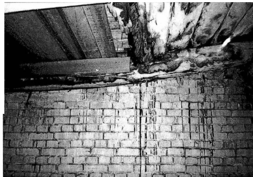
Рисунок 3. Загнивание и излом деревянных конструкций у торцовых стен зданий (из-за постоянного увлажнения атмосферными осадками ввиду разрыва кровли у примыкания к парапету):
