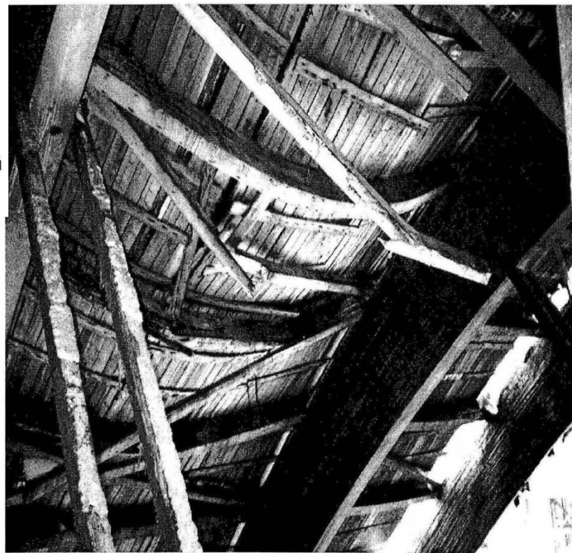
Рисунок 14. Прогиб прогонов покрытия в зоне сверхнормативного отложения снега превышает предельно допустимый прогиб в 2...3 раза
