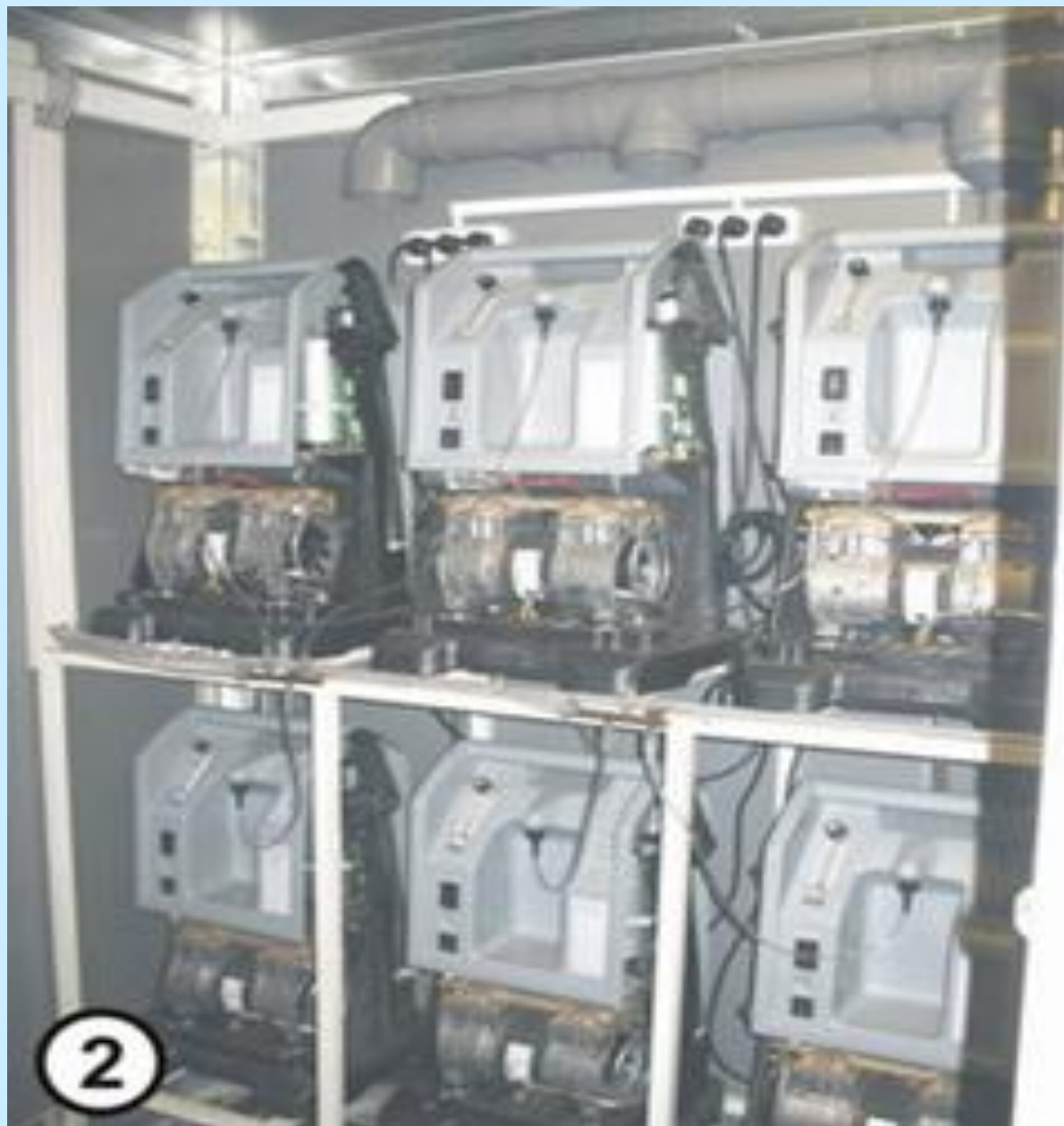
КИСЛОРОДНАЯ СТАНЦИЯ КОМПЛЕКСА
