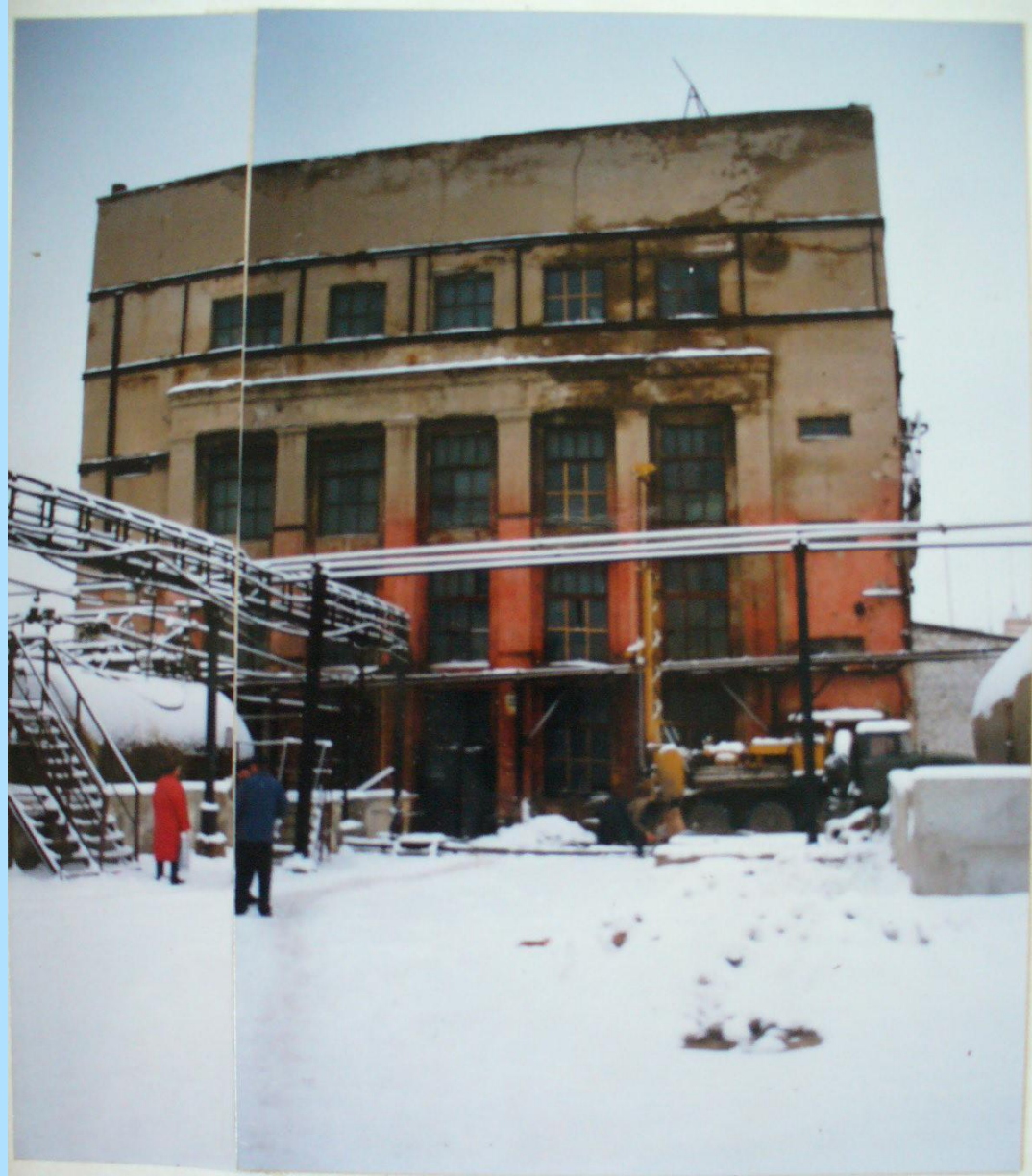
Деформации здания корпуса 322 в АО „Капалактан“, 1995 г.
