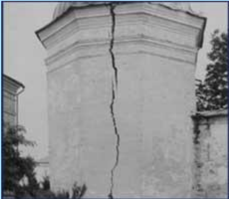
Часовая башня с трещиной. 1926 г.
