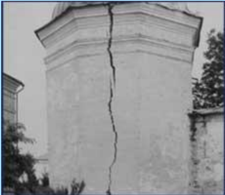
Часовая башня с трещиной. 1926 г.
