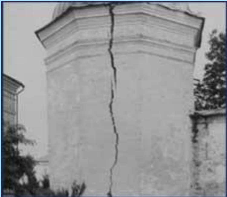
Часовая башня с трещиной. 1926 г.
