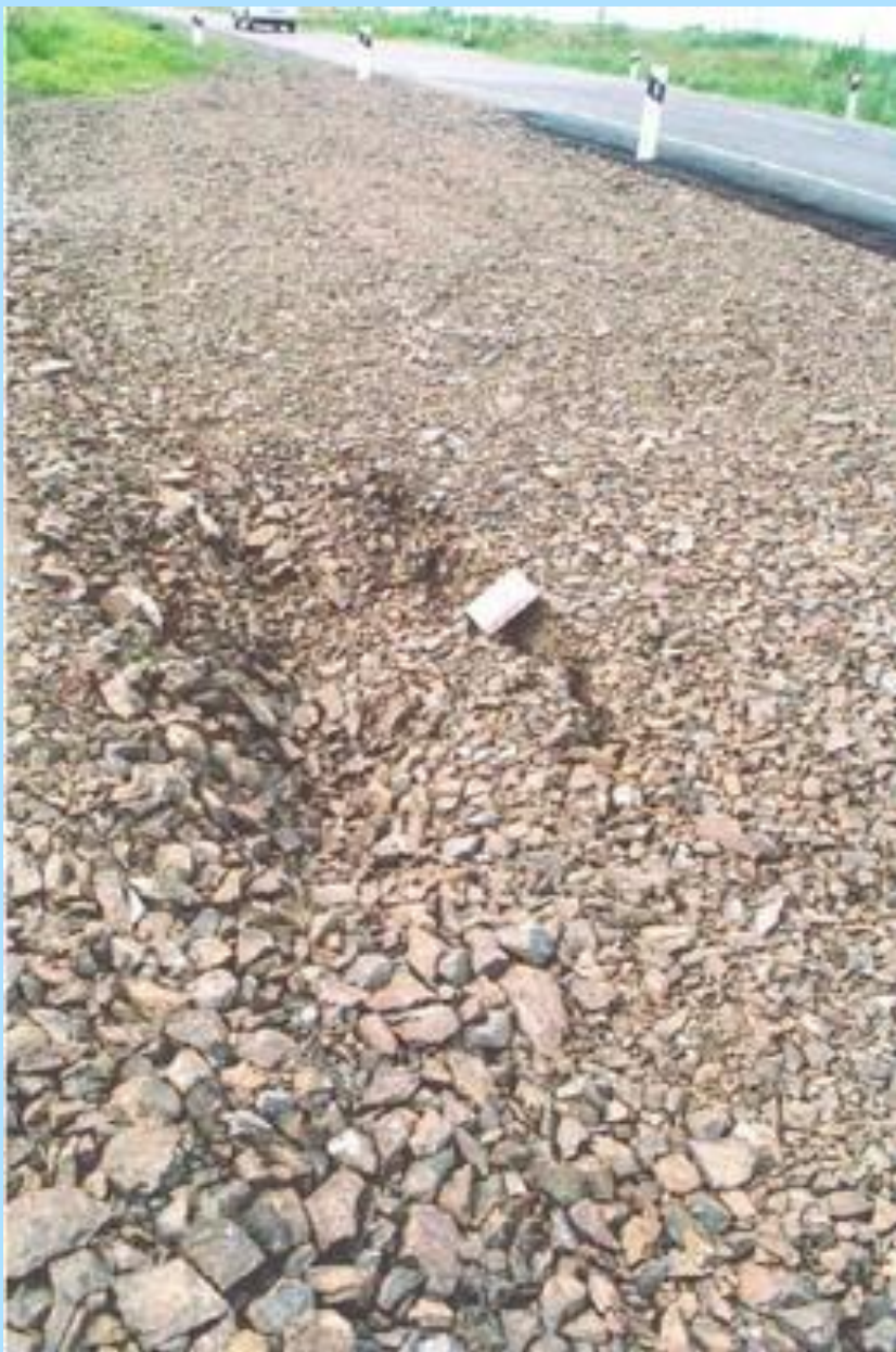
Просадочные воронки на обочине выше по склону над провалами
