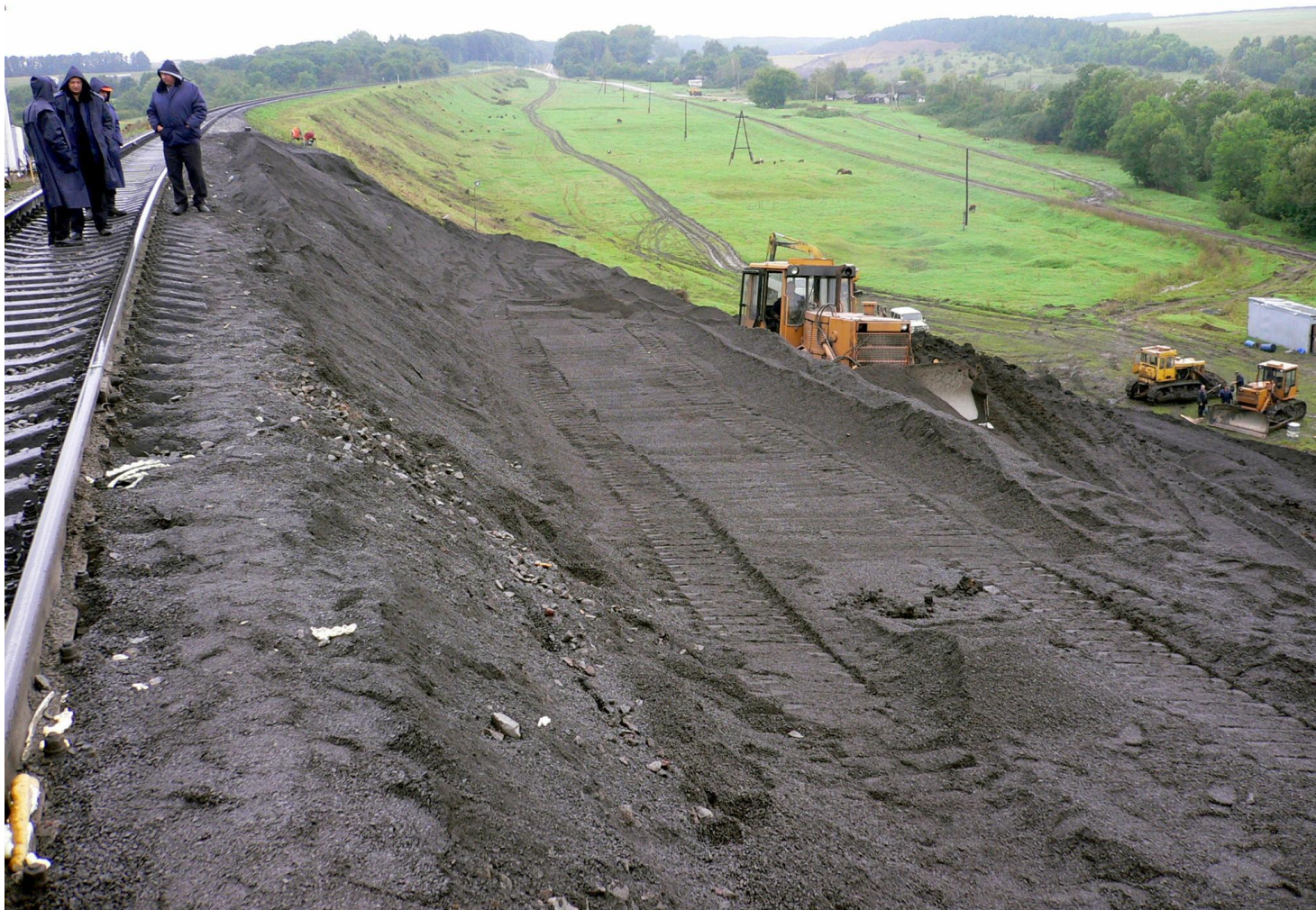
63 км перегон Орел – Верховье. Сплыв откоса высокой насыпи и восстановление его привозным грунтом. Московская ж.д.
