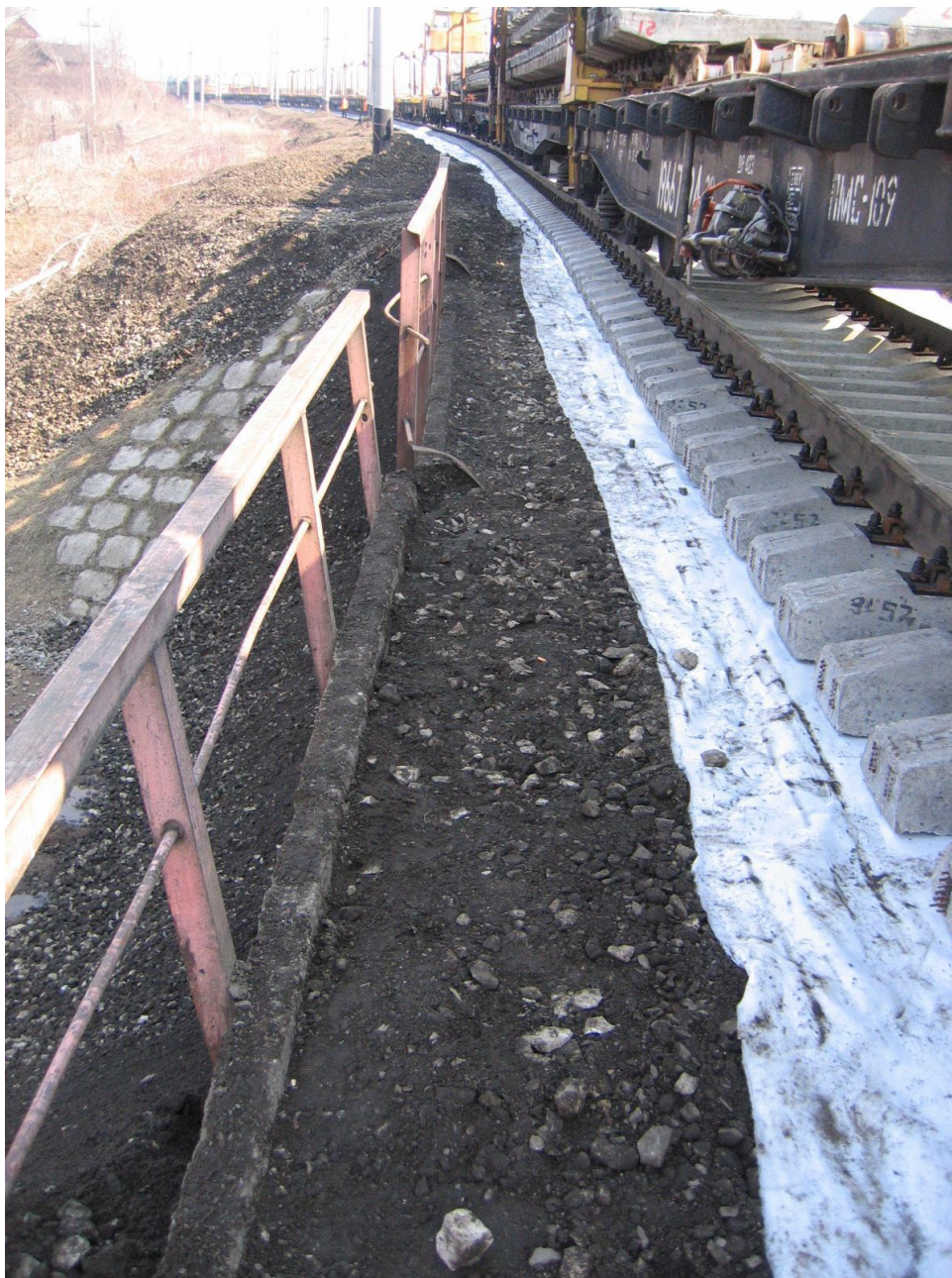
1086 км ПК8 участок Казань – Агрыз. Геотекстиль и грязный старый балласт на мосту. Горьковская ж.д.
