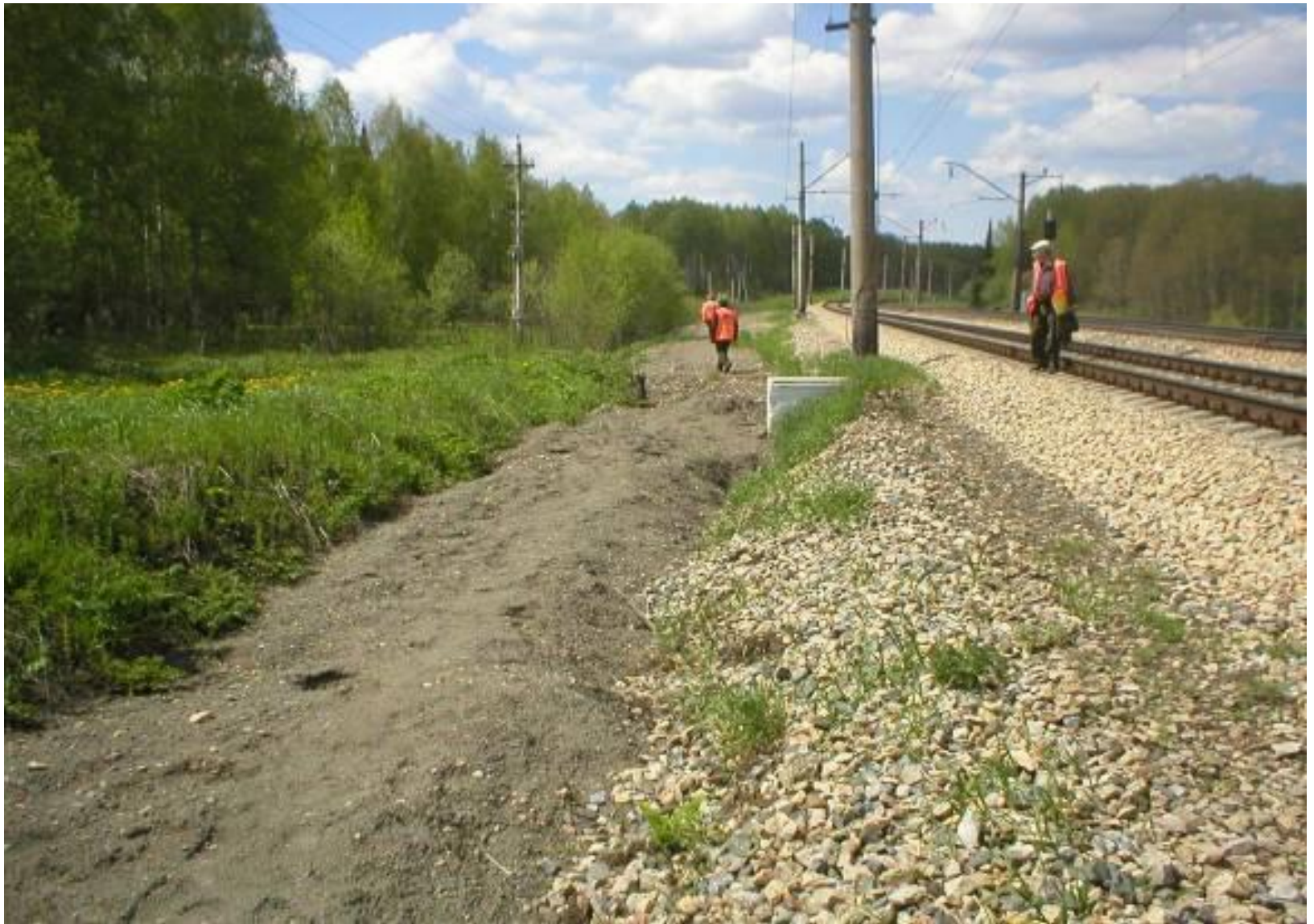
3975 км пк 8, перегона Малиногорка – Кемчуг. Кювет засыпан засорителями. Красноярская ж.д.
